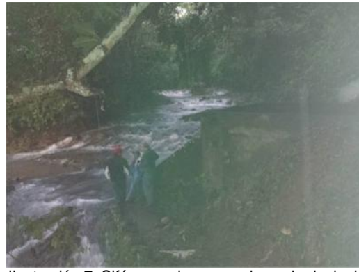
Ilustración 7. Sifón que descarga al canal principal
