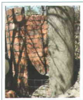
Figura 18. Se coloca el muro, dejando la abertura para la puerta de acceso.
