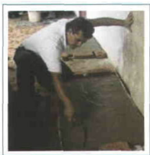
Figuras 35 y 36. Armado y colado de la tapa para la trampa de grasas.
