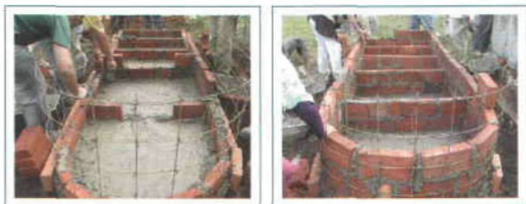
Figura 15.-Colocación del muro con el tabique entrelazado y vista de las cámaras 4 y 5.
