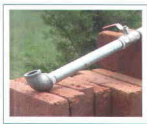
Figura 19. Tubería para la toma de agua.
