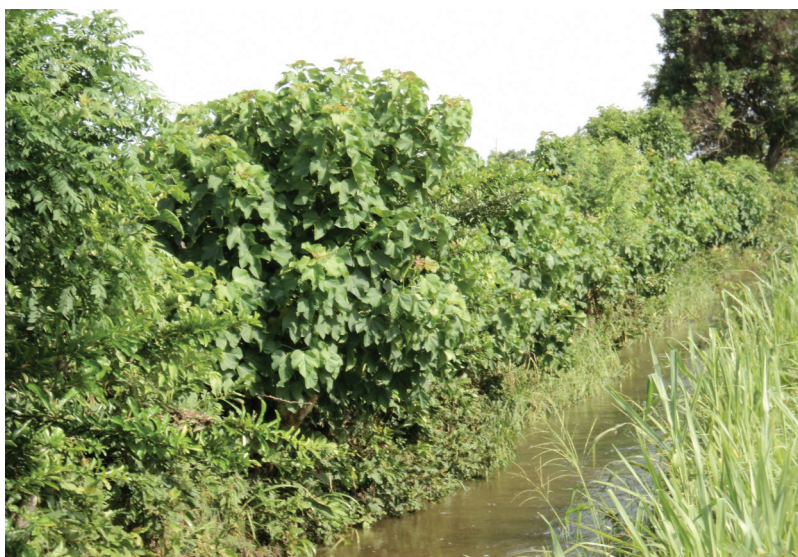
Figura 26. Dren con taludes cubiertos por maleza.
