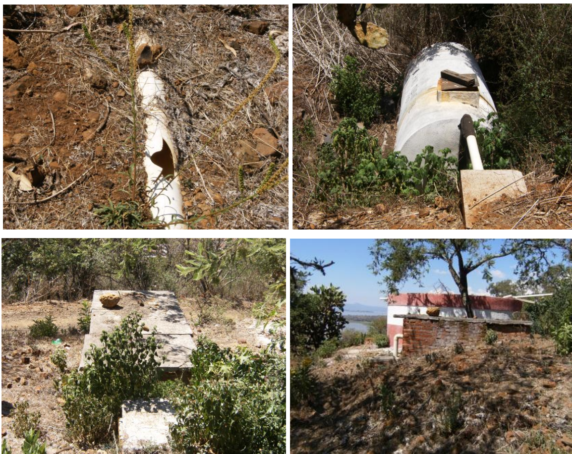
Ilustración 57. Tubería de descarga de aguas residuales en mal estado, tubería rehabilitada y tanques sedimentadores del Sandio (San Jerónimo Purenchecuaro)
