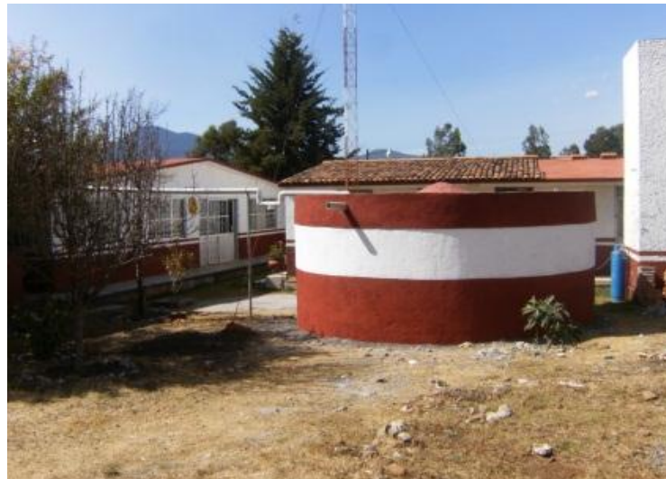
Ilustración 36. Captación, conducción y almacenamiento de agua de lluvia de la clínica del IMSS (San Jerónimo)
