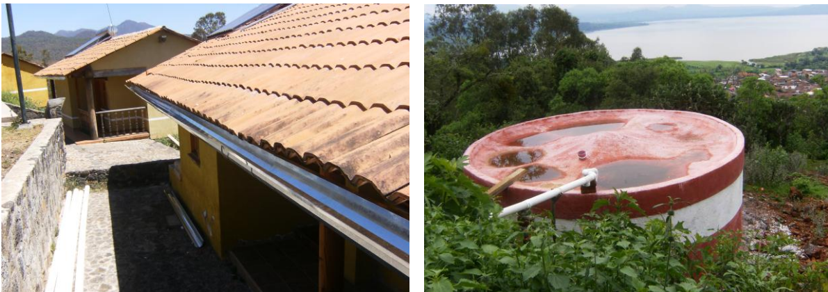
Ilustración 34. Captación, conducción y almacenamiento de agua de lluvia en el cerro de Sandio
