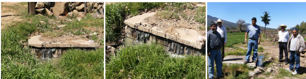
Ilustración 59. Tanque sedimentador - San Andrés Tzironدارو
