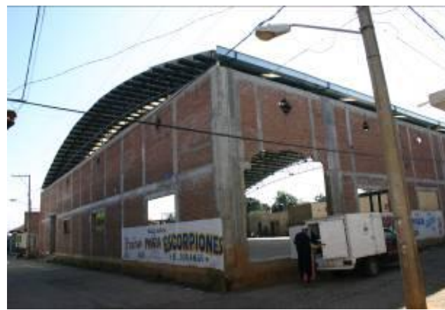
Ilustración 28. Techo de las canchas con canaletas para captar agua de lluvia
