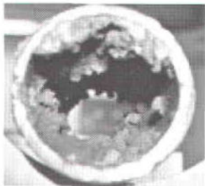
Figura 3.3 El diámetro interno de una tubería se ve afectado en el tiempo.
