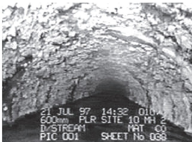
Ilustración 4. Video de la corona interior de un tubo de albañal mostrando la corrosión.
