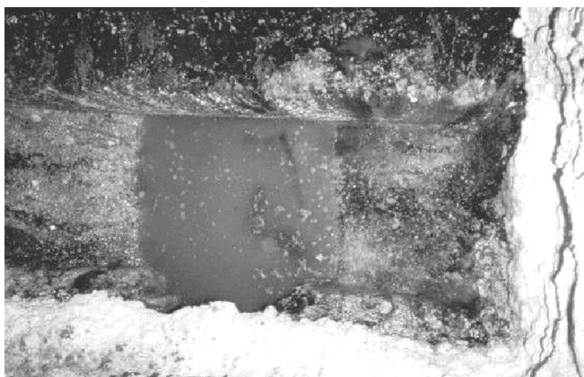
Ilustración 5. Las bacterias en el concreto corroído producen capas de \text{CaSO}_4 .
