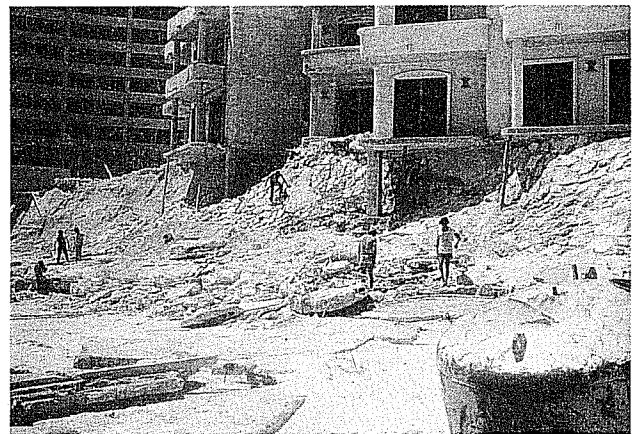
33. Socavación por debajo del nivel de cimentación en la zona hotelera de Cancún
