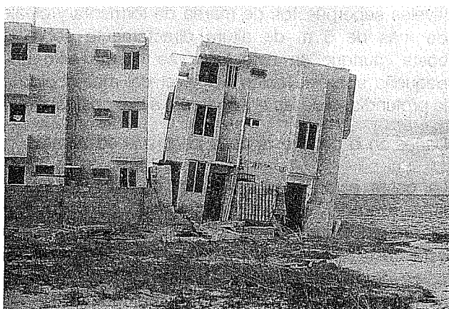
27. Falla de cimentación por erosión (Puerto Juárez, Q.R.)
