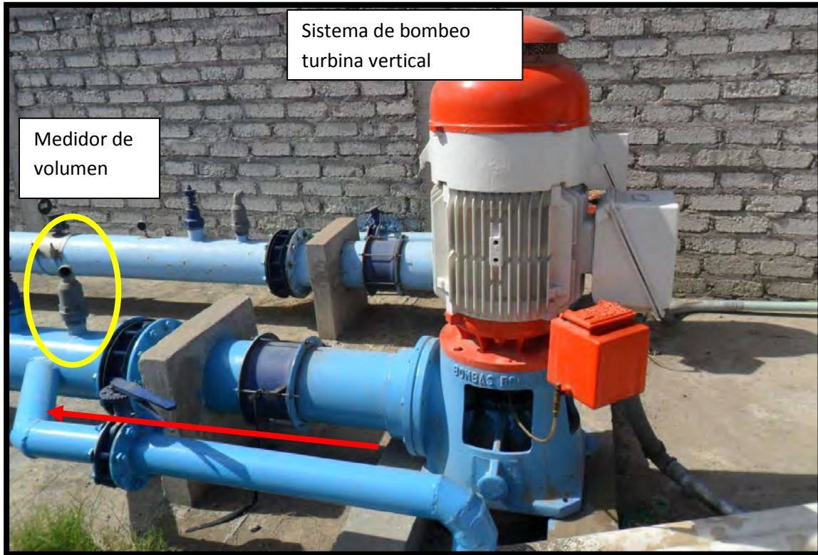
Figura 83. Sistema de bombeo turbina vertical
