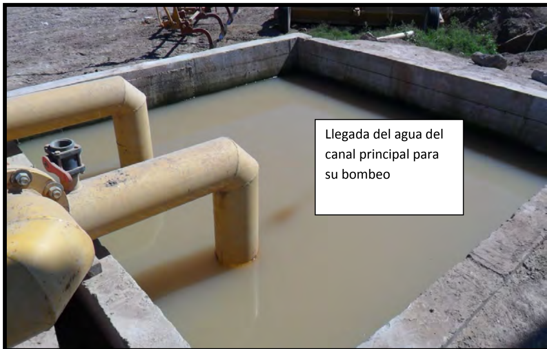
Figura 72. Depósito de agua
