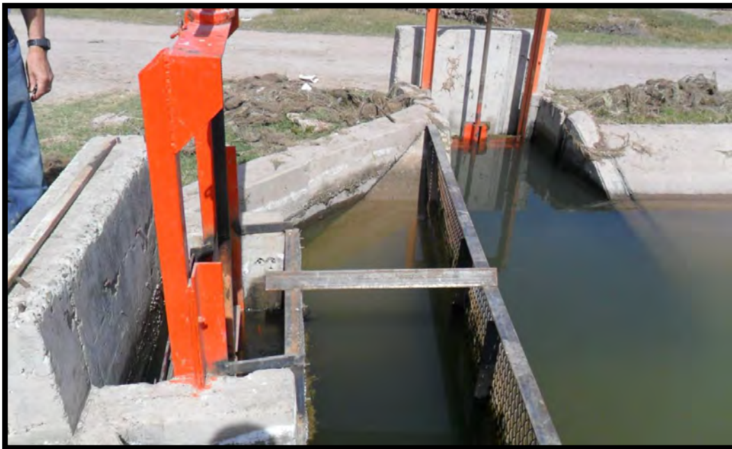
Figura 82. Toma de agua del fin de canal, y llevada a un estanque para su bombeo.
