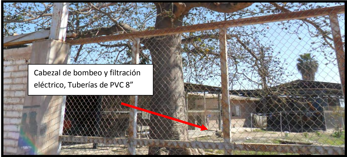
Figura 77. Cabezal de bombeo
