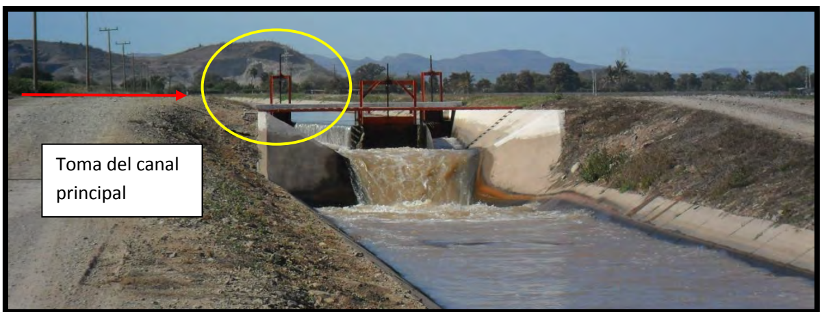
Figura 78. Compuerta deslizante en canal principal
