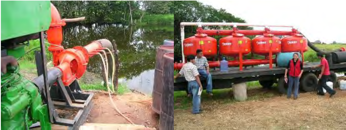
Figura 9.2 Fuente de abastecimiento de agua superficial para riego y sistema de filtrado de grava y arena.
