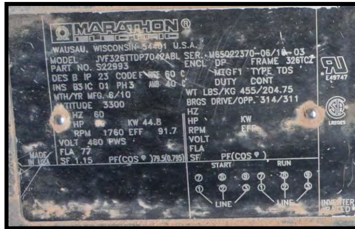
Figura 75. Placa técnica de bomba
