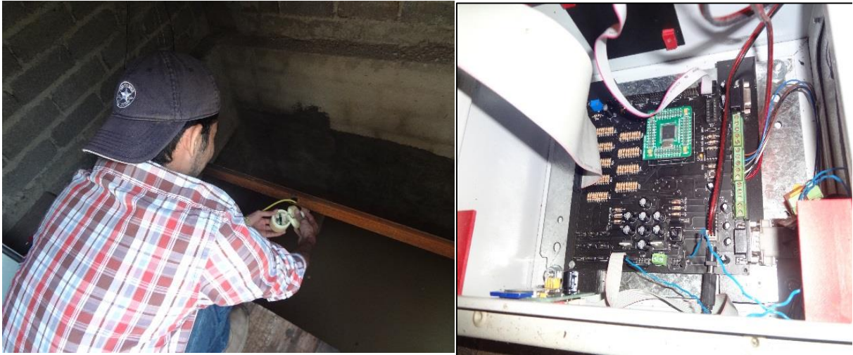
Ilustración I.71. Cambio de rondanas oxidadas en la batería de la microcuenca Ichupio.
