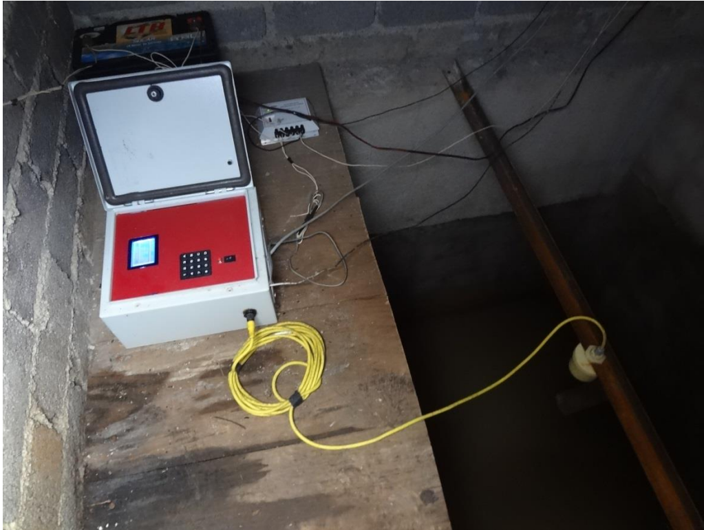
Ilustración 1.73. Equipo medidor con sensor ultrasónico después del mantenimiento y listo para registrar información en la microcuenca Ichupio.
