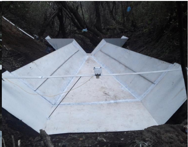
Aforador y sensor
