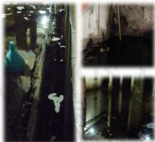
Figura 4.7 Tanque de almacenamiento de agua residual, industria Gütermann
