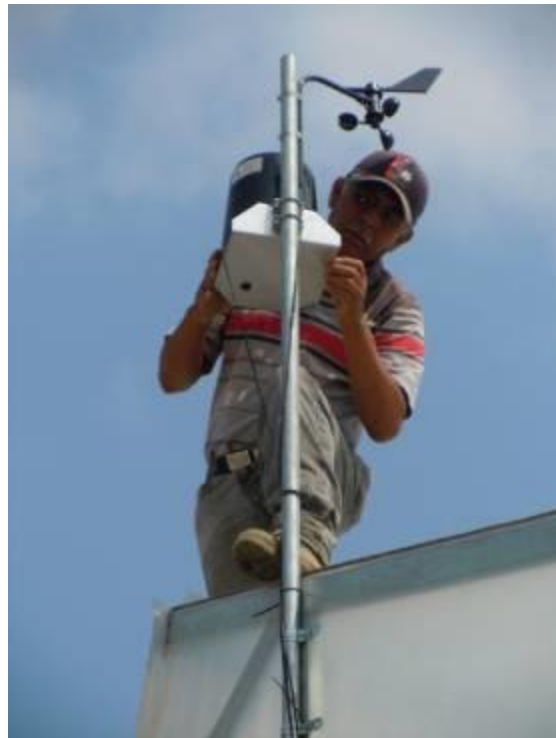
Imagen 1.10 Anemómetro e instalación del nuevo pluviómetro en el techo del invernadero (Imagen tomada 25 mayo 2012).
