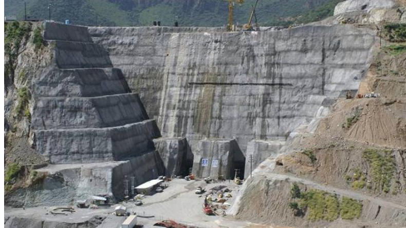
Figura 5. Obra de toma del proyecto hidroeléctrico La Yesca
