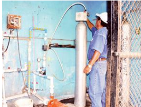
Figura 26. Cloración con gas en un sistema de agua potable
