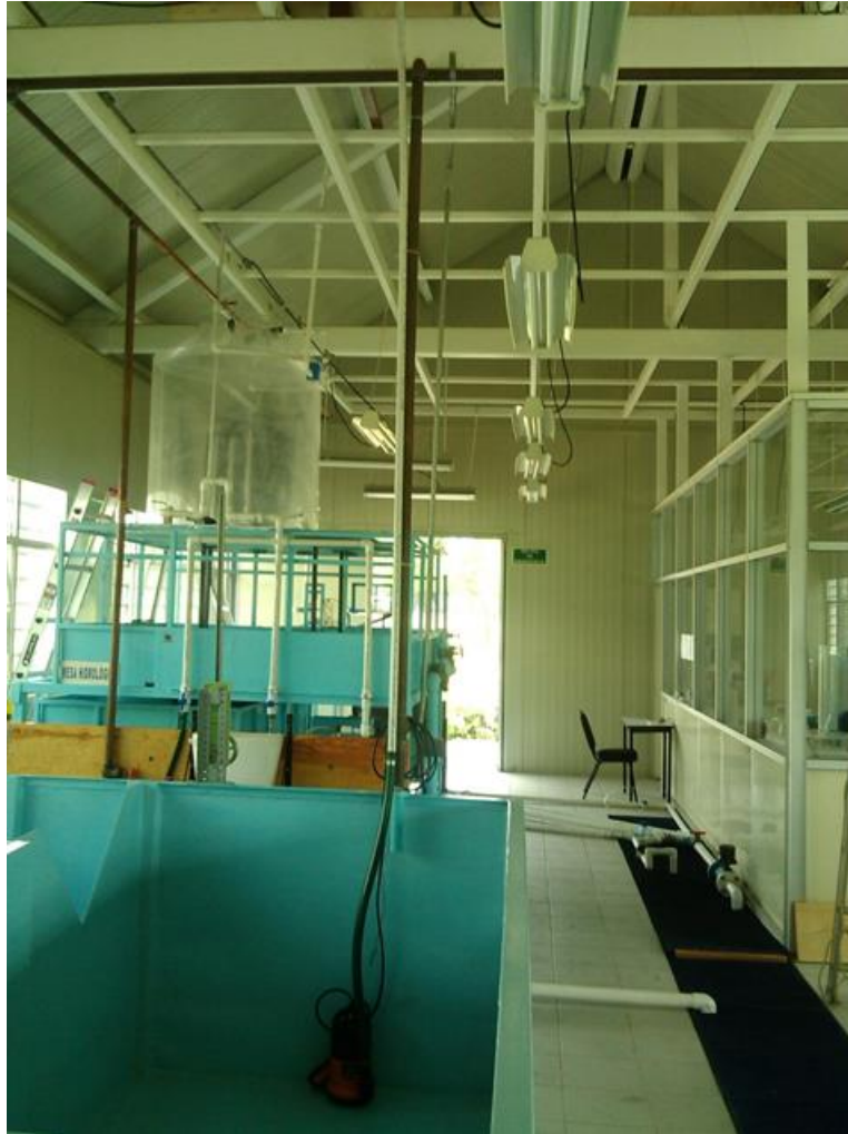
Ilustración 5. Depósito de agua de 2,000 litros con bomba sumergible.
