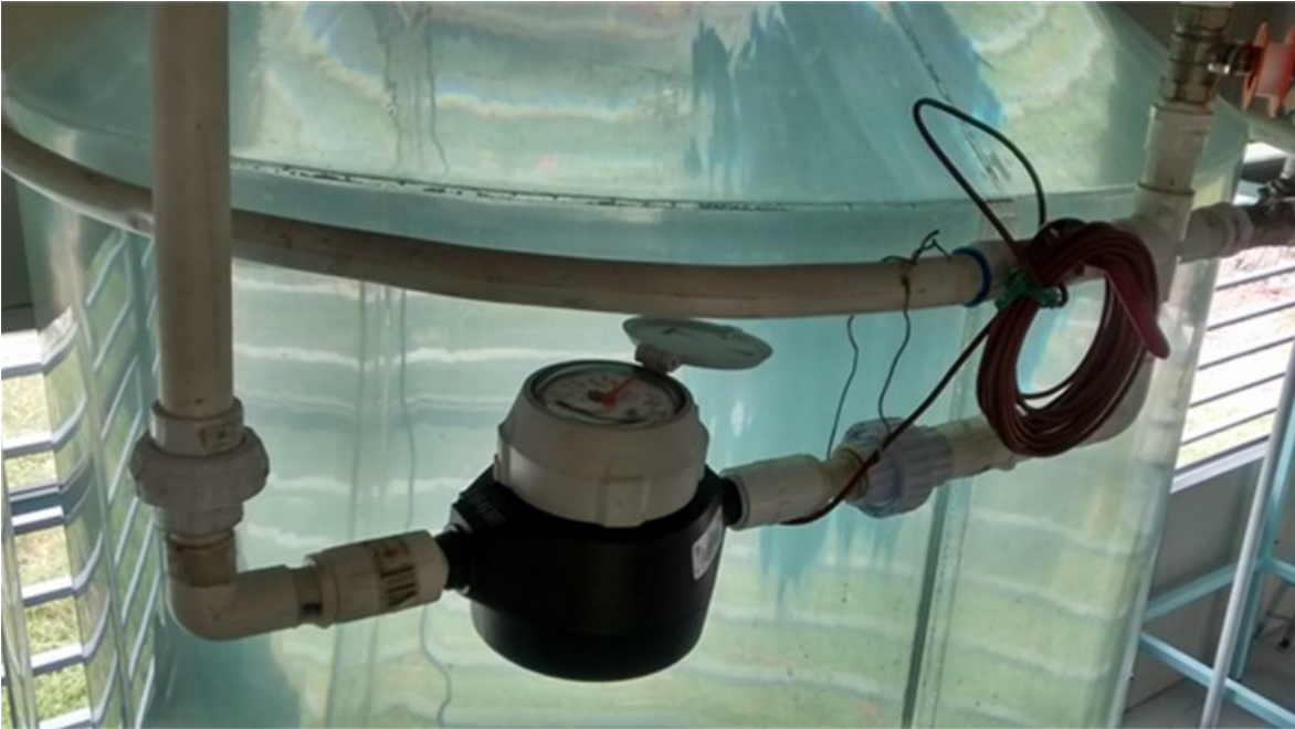
Foto 19. Instalación del micromedidor domiciliario antes del depósito.
