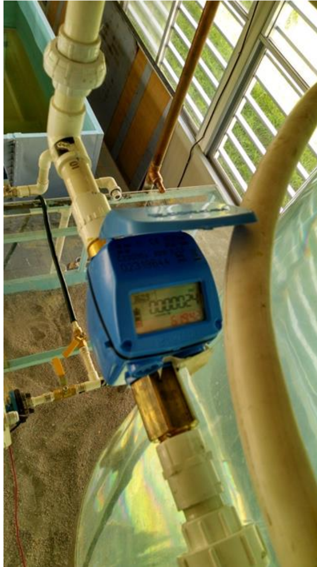
Ilustración 2. Medidor de caudal de entrada.
