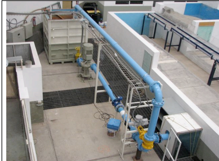
1 Instalación, vista general
