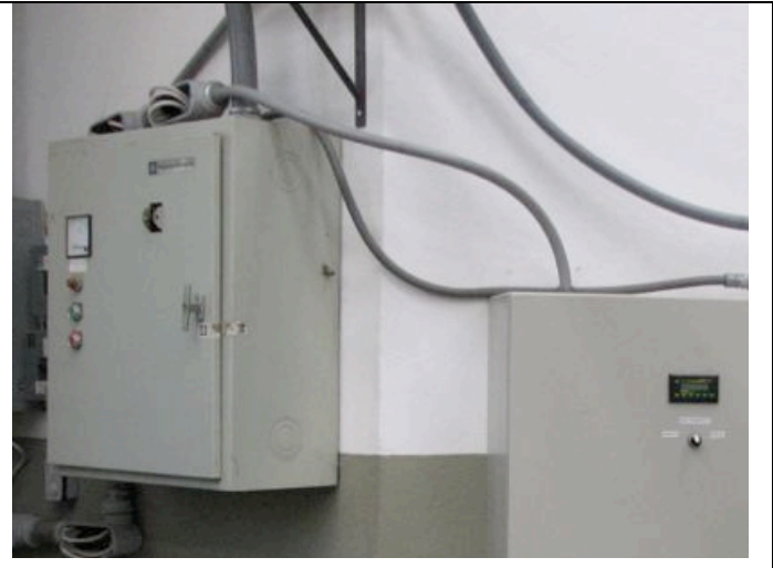
14 Tableros electrico y electrónico
