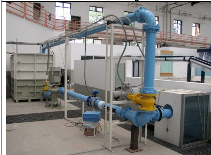
7 Instalación, vista general
