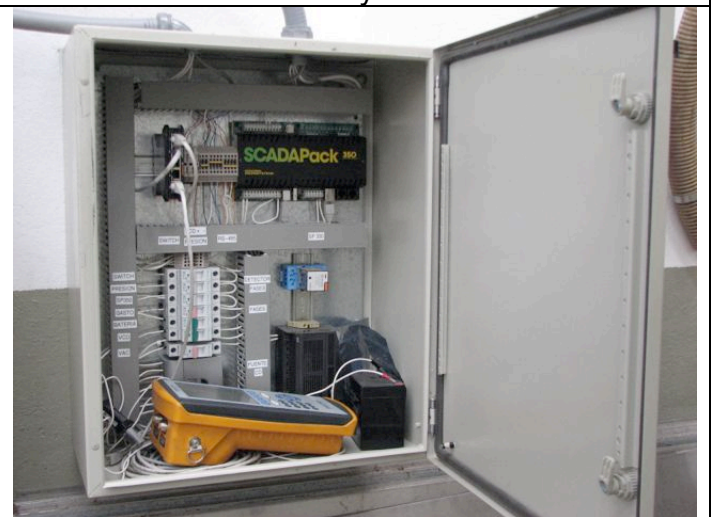
24 Unidad terminal remota con fuente de alimentación
