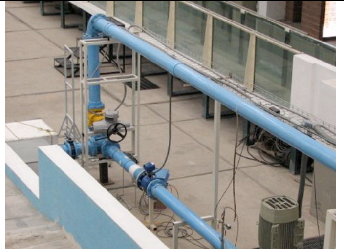
6 Instalación, vista general
