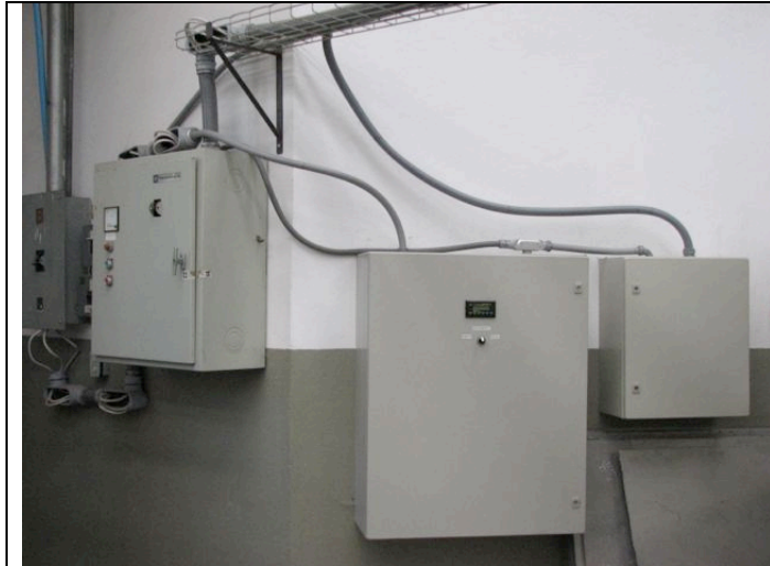
13 Tableros electrico y electrónico
