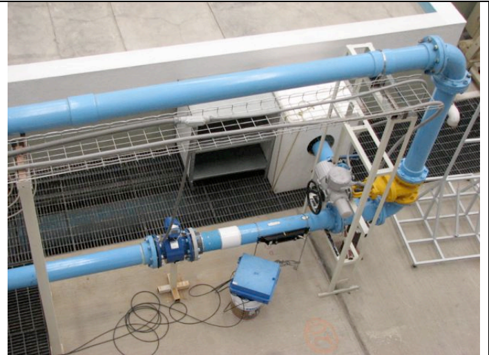
2 Aforador y válvula para presurizar
