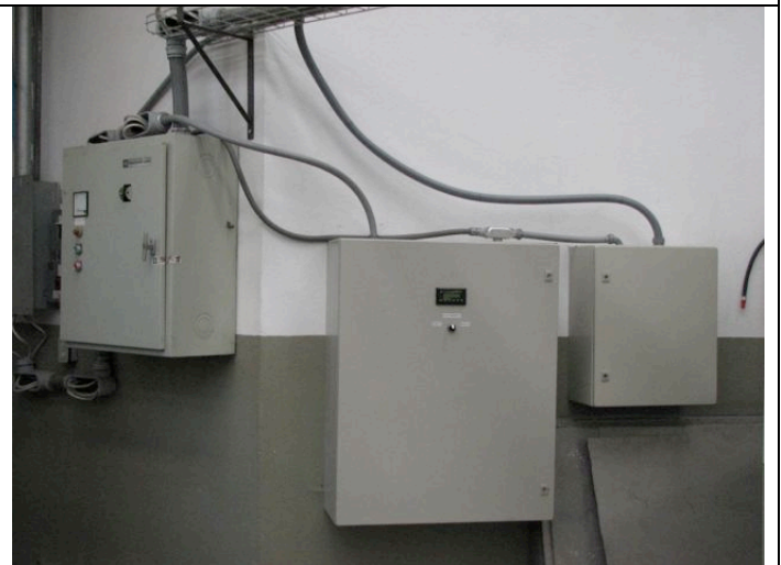
12 Tableros eléctrico y electrónico
