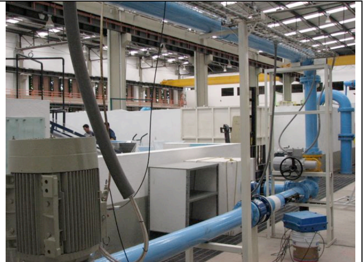
10 Línea de conducción
