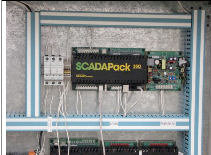
21 Unidad terminal remota
