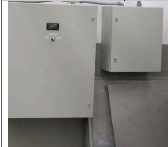
15 Tableros electrico y electrónico
