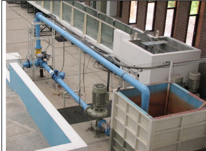
5 Instalación, vista general
