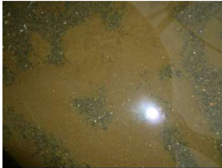
Foto 5.5 Acumulación de sólidos sobre el lecho de filtración
