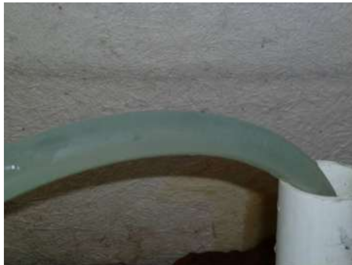
Foto 5.4 Descarga de agua a desagüe
