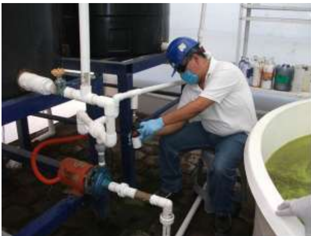
Foto 5.9 Toma de muestra entrada del filtro
