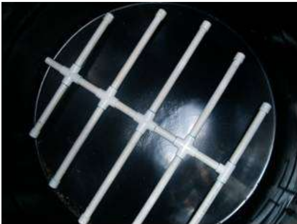
Foto 5.1 Ramal de distribución de agua en el interior del filtro
