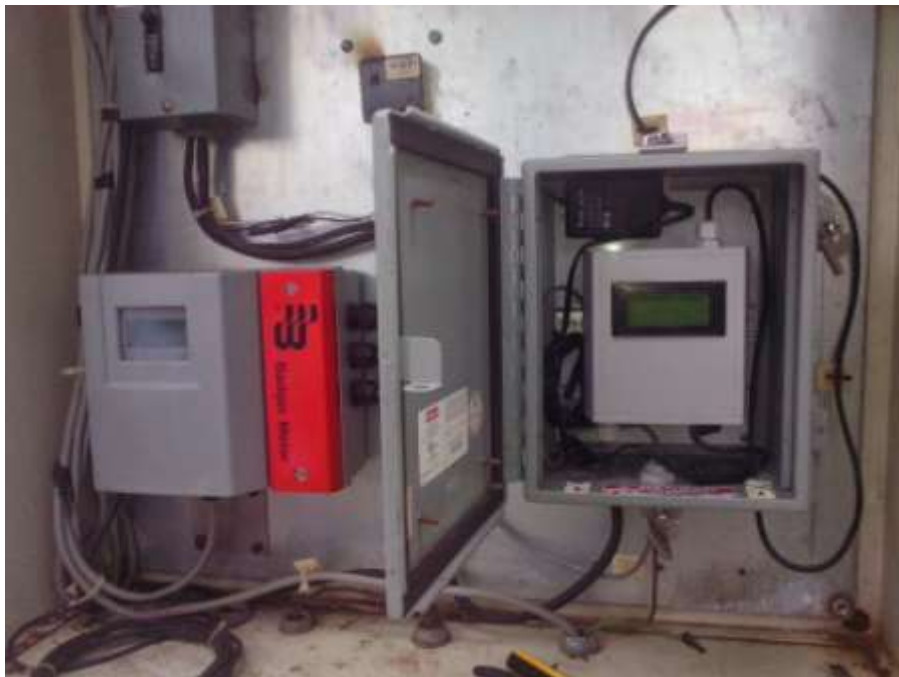
Equipo que permite la adquisición y envío de datos por medio de la red GSM (telefonía celular) para el medidor de flujo electromagnético de la marca Badger Meter de la Estación Piloto IMTA "Pozo".
