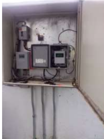
Equipo desarrollado para la captura automática y transmisión de datos del medidor de flujo de agua.
