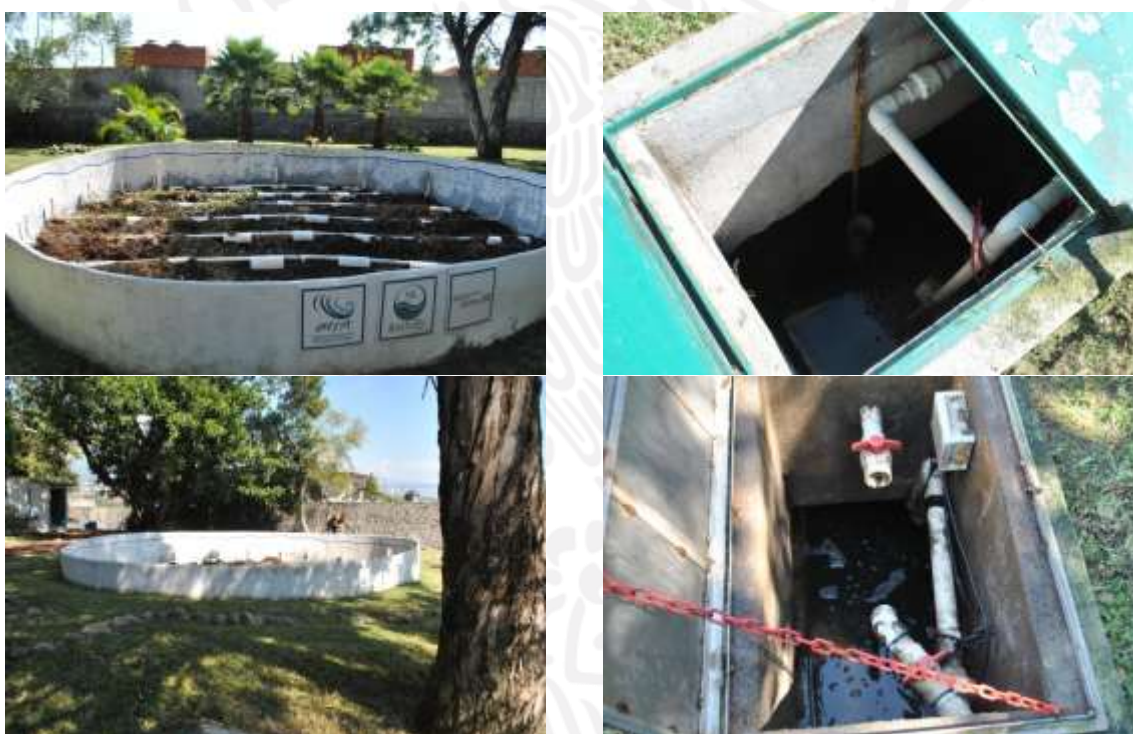
Figura 3.5. Mantenimiento del sistema BIOTROP™
