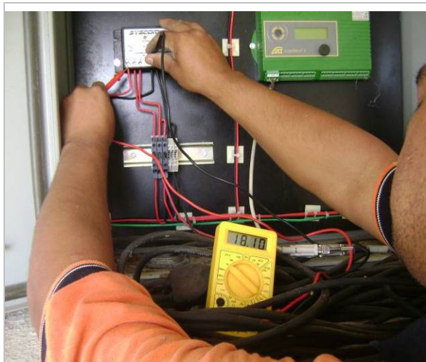
INSTALACIÓN DEL SISTEMA DE TELEMETRÍA
