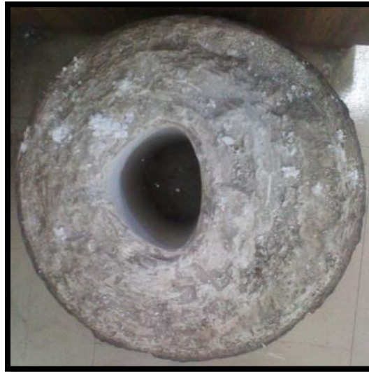
Ilustración 1. Ejemplo de incrustación en las tuberías (Foto propia).
