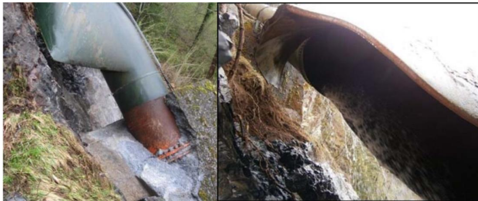
Figura 2.1. Ruptura de una línea de conducción causado por un cierre instantáneo en Francia (Kueny, Combes, Lourenço, Clary, & Ballester, 2014)
