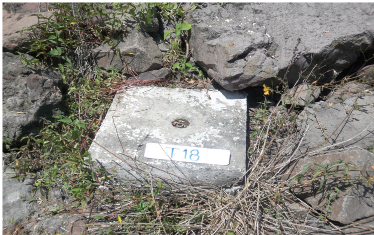
Foto 3. Testigo superficial instalado en la cortina de la Presa Madín.
