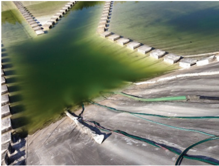
Figura 32. Retiro del agua que se encuentra por encima de la cubierta flotante.
