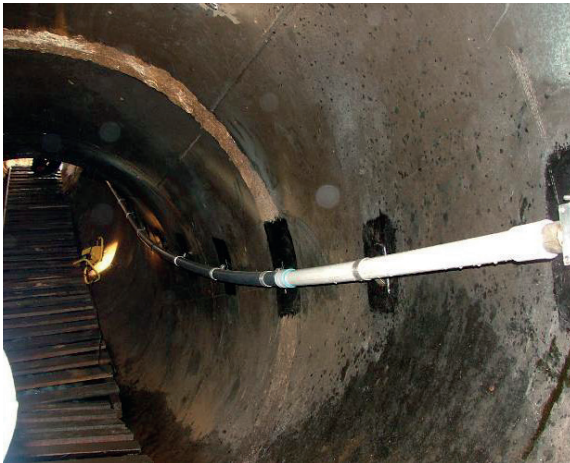
Figura 3.39 Otra vista del desarrollo de tubería de PVC en el interior de la tubería.
