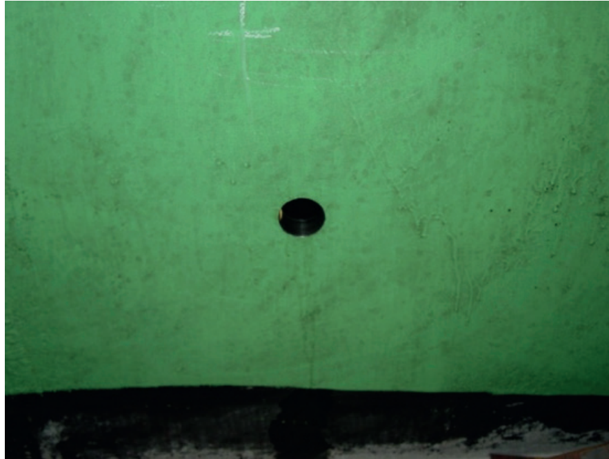
Figura 2.61 Orificio visto desde el exterior del conducto.
