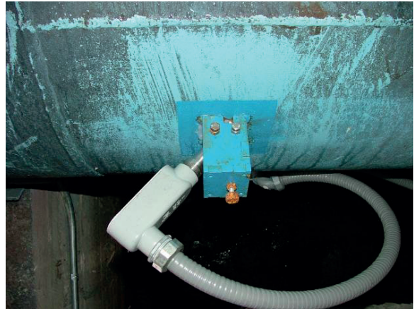
Figura 3.26 Vista del sensor con su placa soldada.
