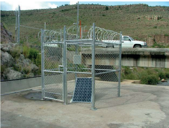
Figura 3.23 Cerco de malla ciclónica para protección de celdas solares.
