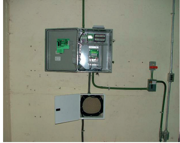
Figura 3.42 Vista de la unidad electrónica en la caseta de operación.
