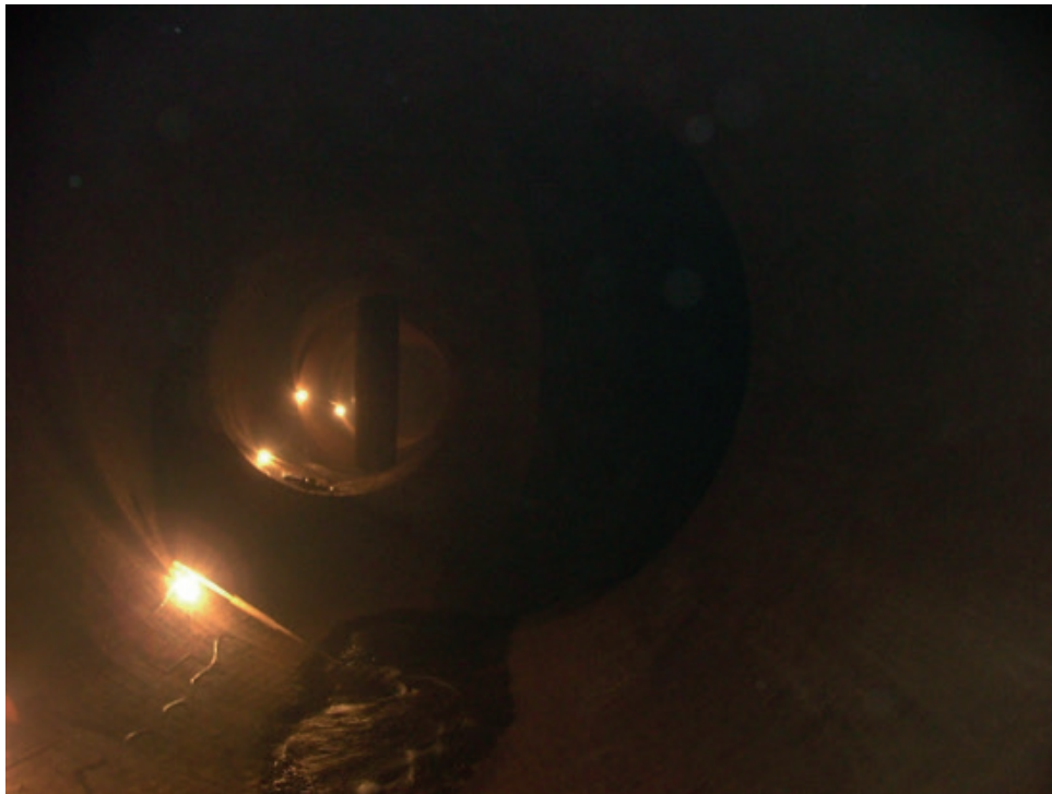
Figura 2.13 Iluminación de la obra de conducción.
