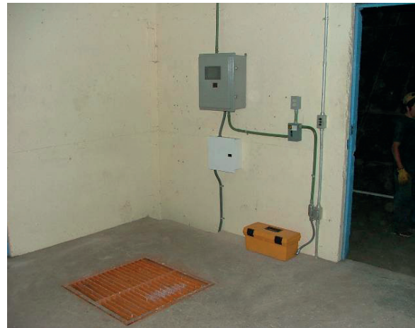
Figura 3.44 Gabinete que aloja la unidad electrónica en la caseta de operación.
