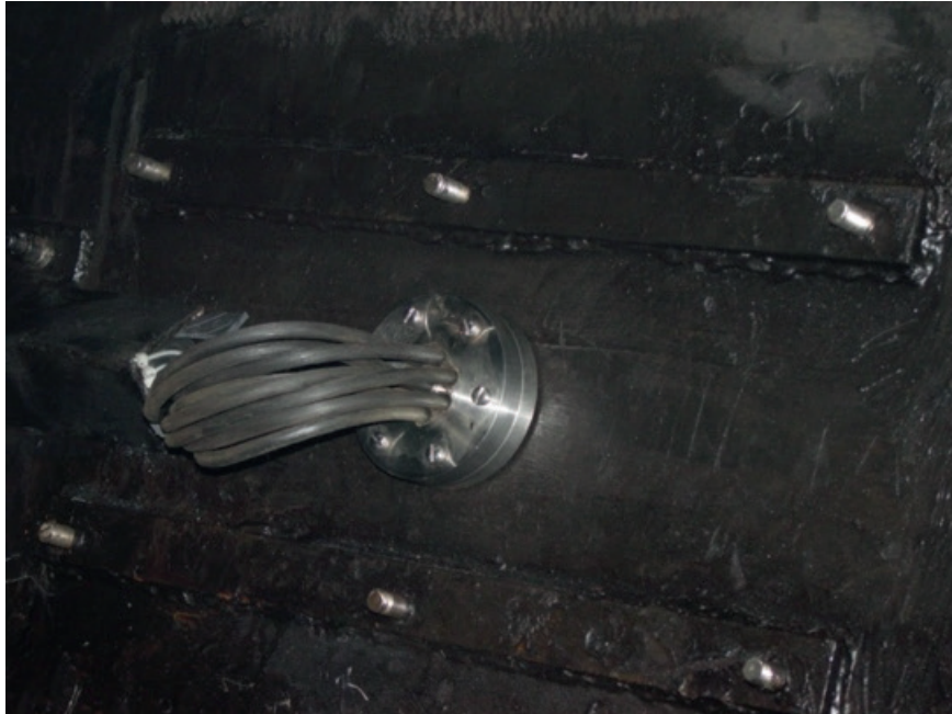
Figura 2.63 Vista interna una vez que el dispositivo es colocado.
