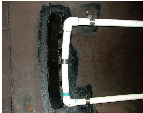
Figura 3.36 Deflector para proteger tubería de PVC.
