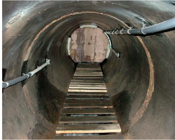
Figura 3.38 Vista del desarrollo de tubería de PVC. Se aprecia el par de sensores.
