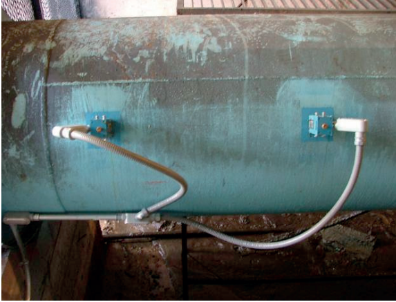
Figura 3.25 Sensores en la tubería en arreglo V.
