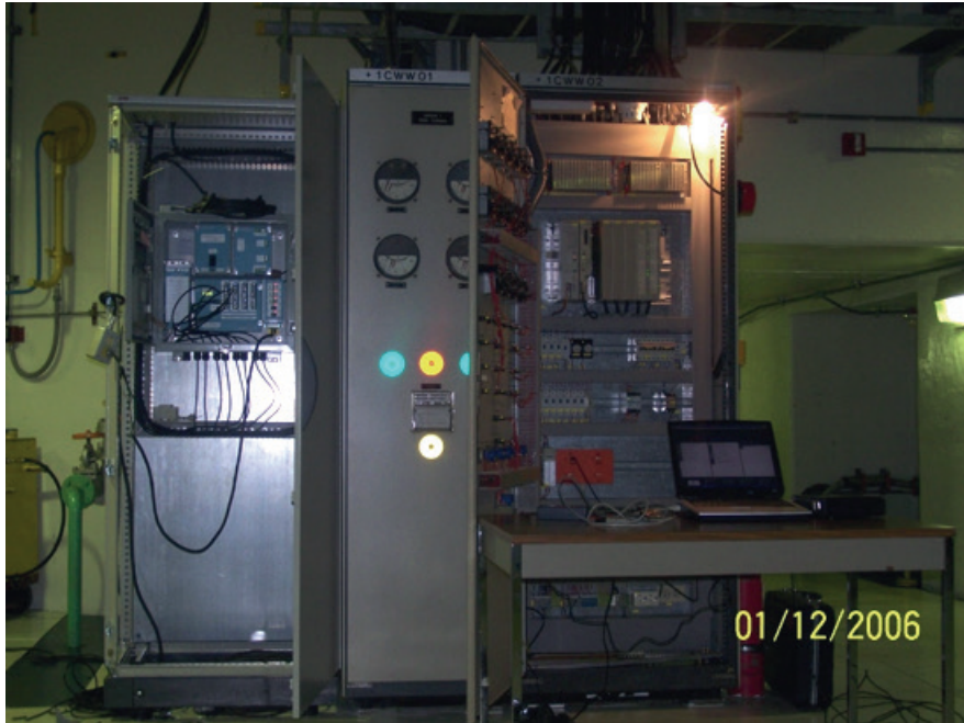
Figura 2.67 Líneas de señales electrónicas conectadas al medidor.
