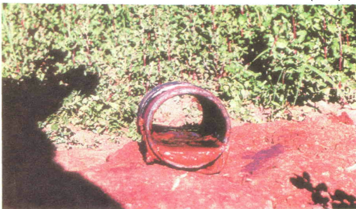
Foto 31. Tramo de dren lateral con filtro geotextil mostrando taponamiento con partículas finas
