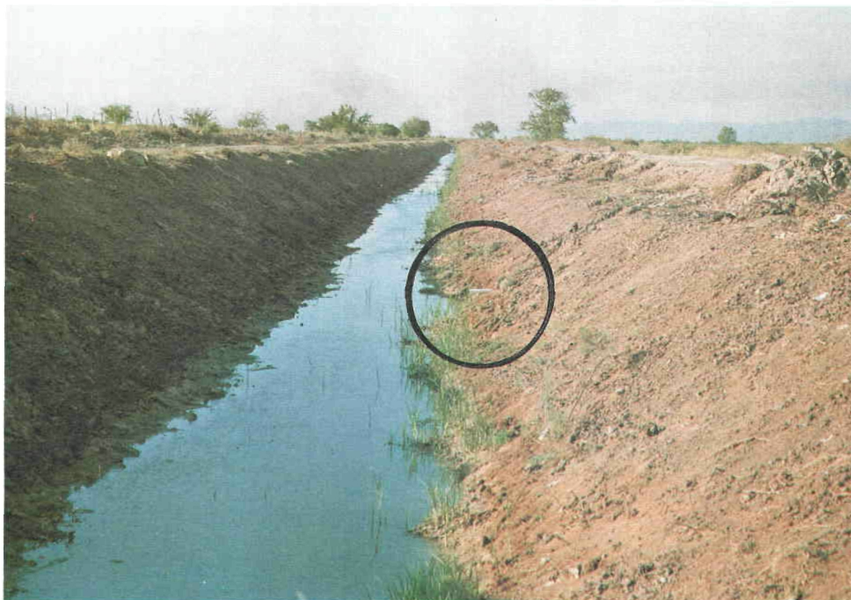
Foto 1. Dren de la red general en condiciones adecuadas en donde se señala la descarga de un colector parcelario (ver círculo)
