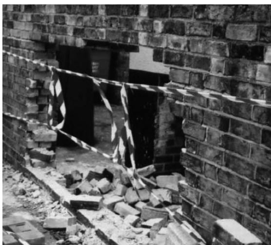
Figura 12. Falla en muro de mampostería en Cambridge, Reino Unido, diciembre de 2001. Fuente: Kelman (2002).
