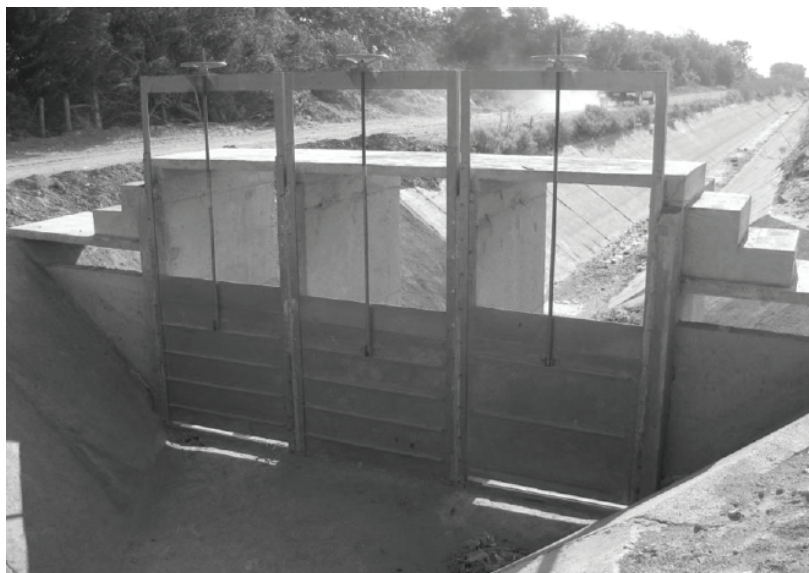
Figura 72. Represa de tres compuertas planas, deslizantes, tipo guillotina o verticales. Dimensiones 1.45m x 1.62 m y vástago de 3.58 m de longitud, para una capacidad de 10.500 m 3 /s. Canal El Barrote, del DR 026 Bajo Río San Juan, Tam.
