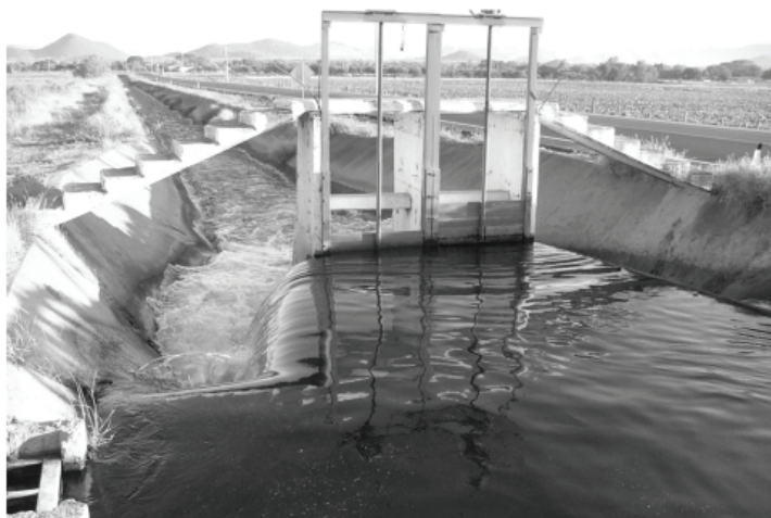
Figura 81. Vertedor de cresta larga en el canal lateral 13+200, Distrito de Riego 097 Lázaro Cárdenas. Cortesía del Dr. Serge Tamari.
