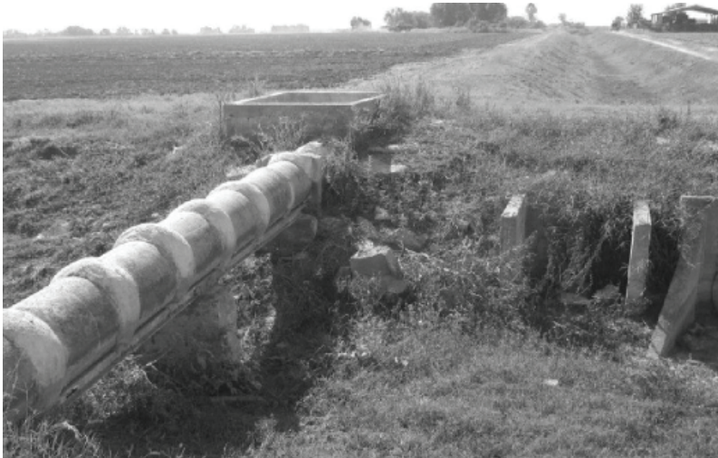
Figura 94. Puente canal de tubería de concreto de 24", de 150 lps de capacidad, para cruzar un canal cuyo claro es de 10 m, ubicado en el módulo III-4 del DR 025 Bajo Río Bravo, Tam.
