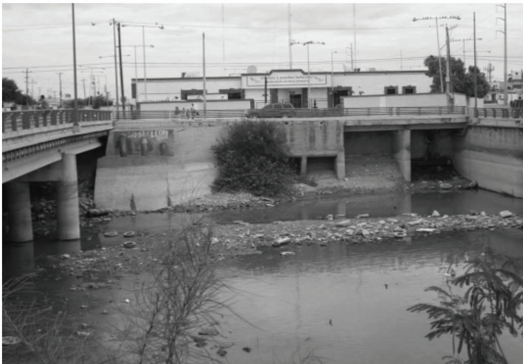
Figura 99. Desagüe total en el Km 8+000 del canal Anzaldúas, actualmente en desuso al ser eliminada la represa del canal y rellenado el dren Reynosa Poniente, donde se descargaban totalmente las excedencias del canal hacia el río Bravo. El terreno federal, resultado del relleno del dren, fue utilizado para construir oficinas federales e instalaciones recreativas del municipio de Cd. Reynosa, Tam.
