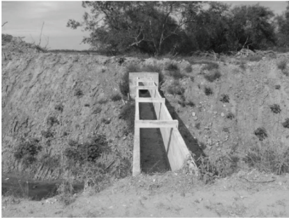
Figura 95. Puente canal de concreto de 250 lps de capacidad, 0.60 m de base, 1 m de alto y muros de 10 cm de espesor para cruzar un dren cuyo claro es de 15 m. Módulo de Riego II-2 del DR 025 Bajo Río Bravo, Tam.
