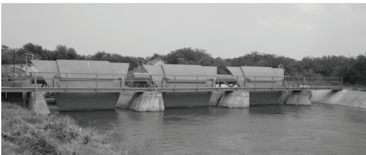
Figura 78. Compuertas tipo AMIL metálicas, Km 21+400 del canal Rode, vista desde aguas arriba. Nótese el tanque de flotación al frente. Capacidad de diseño 60m 3 /s. DR 026 Bajo Río San Juan, Tam. Cortesía del Dr. Ariosto Aguilar Chávez.
