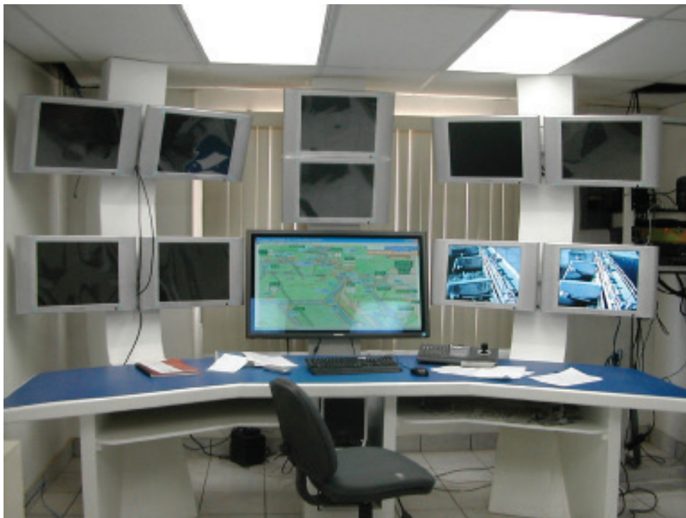
Figura 17. Central de control del sistema de monitoreo. Distrito de Riego 037 Río Colorado. Foto cortesía del Dr. Víctor M. Ruiz Carmona.
