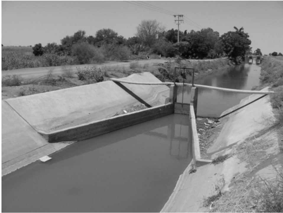
Figura 82. Vertedor de cresta larga en el Distrito de Riego 041 Río Yaqui, con compuerta deslizante al frente.
