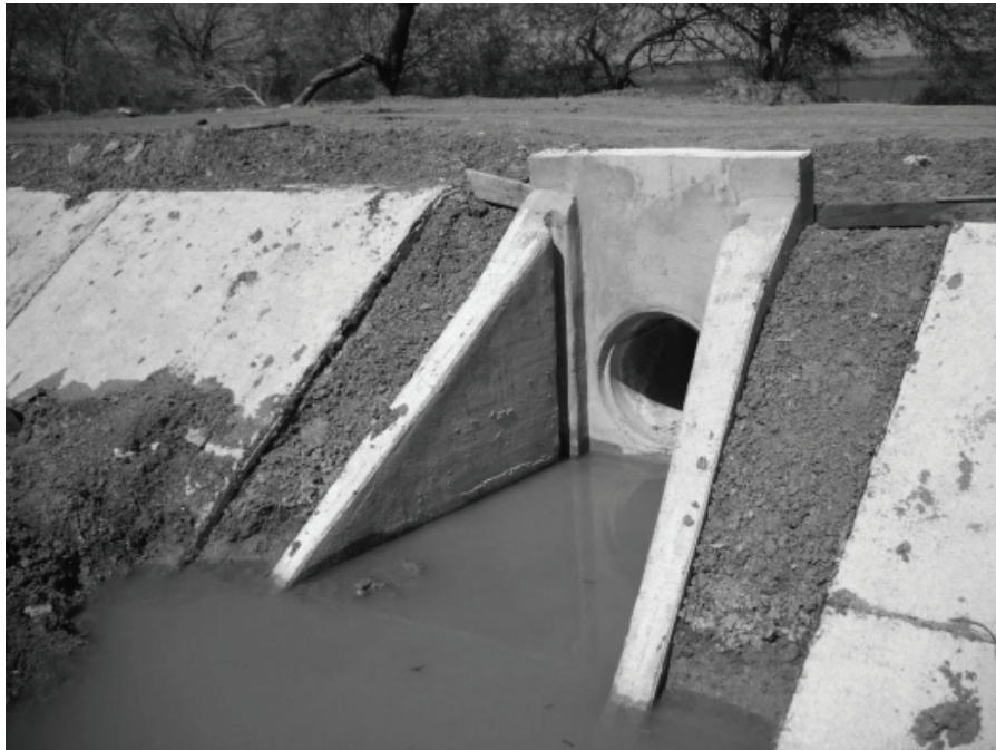
Figura 84. Conducto preparado para colocar compuerta tipo Miller para toma granja. Canal 12+570 del DR 025 Bajo Río Bravo, Tam.
