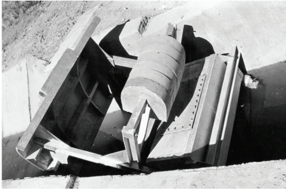
Figura 92. Compuerta AVIS localizada en uno de los canales de la zona de riego Miguel Auza, Zacatecas.
