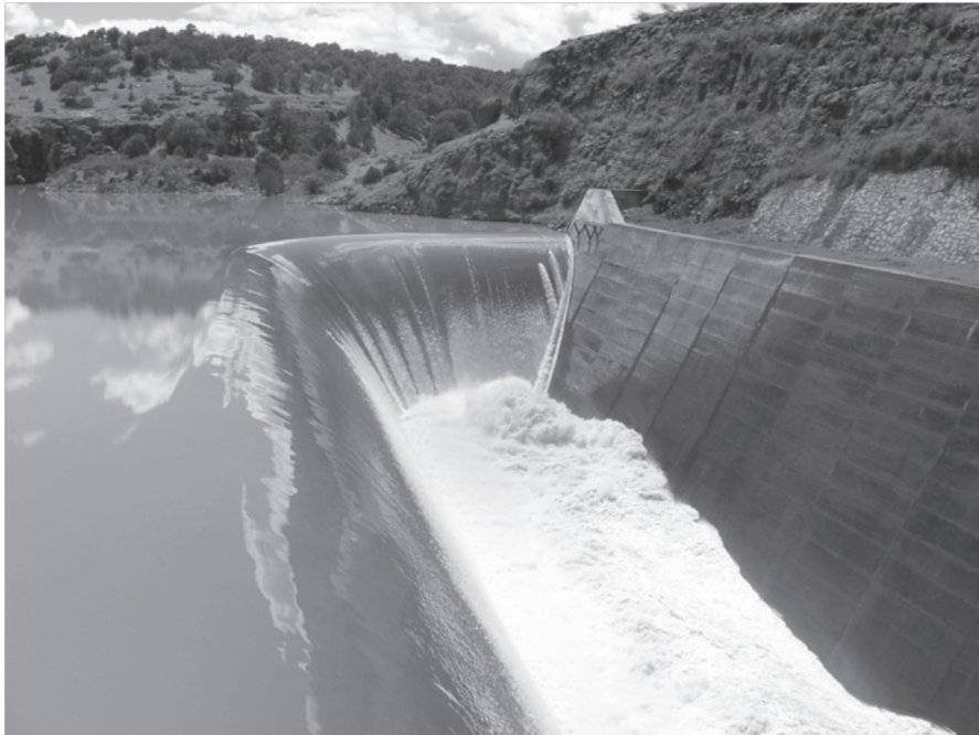
Figura 66. Obra de excedencias tipo vertedor lateral de cresta libre de la presa Abraham González, también conocida como Papigochic, en Chihuahua.
