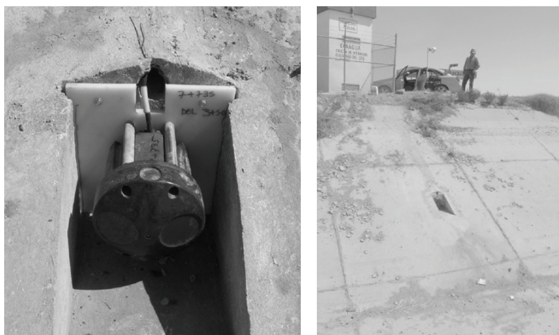
Figura 51. Colocación de un sensor Doppler montado en placa de nailacero, en un “nicho”. Canal lateral 3+500, DR 017 Región Lagunera, Coah.-Dgo. Esta forma de montaje del sensor reduce sustancialmente el vandalismo, al no tener cables a la vista y los efectos provocado por los herrajes de aluminio.
