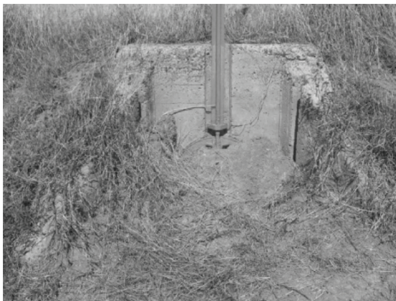
Figura 86. Toma-granja tipo Miller azolvada intencionalmente para evitar filtraciones del canal al terreno de riego. Se debe de desazolvar, previo al inicio del siguiente periodo de riegos. Módulo II-2 del DR 025 Bajo Río Bravo, Tam.
