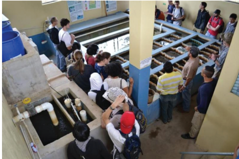
Figura 4-23: Planta de clarificación tipo AguaClara de 6 L/s en Cuatro Comunidades de Amarateca, Honduras. En la pila a la izquierda se realiza la coagulación, el tanque a la derecha es el floculador hidráulico vertical, y los dos tanque idénticos al fondo son sedimentadores de flujo ascendente con placas (fuente: AguaClara y Agua Para el Pueblo).
