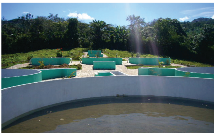
Figura 4-9: Filtro lento de estructura de ferrocemento en la planta FiME de San Pedro de Tutule, La Paz, Honduras. Tres filtros lentos comprenden la última etapa de filtración en esta planta.
