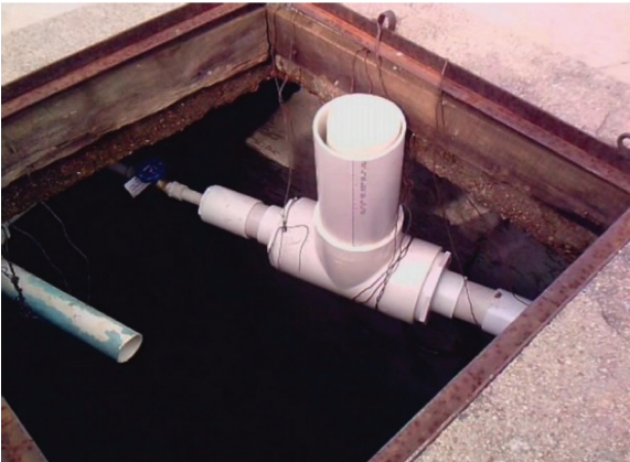
Figura 4-30: Clorador de tabletas hecho de tubos PVC instalado en un tanque de almacenamiento en Honduras (fuente: ADEC).
