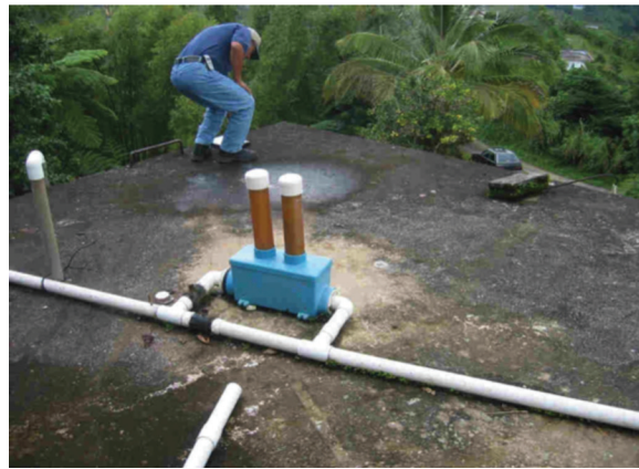
Figura 4-31: Clorador de tabletas tipo Norweco instalado en Puerto Rico (fuente: http://www.technical-consulting.com/non-prasa.htm ).
