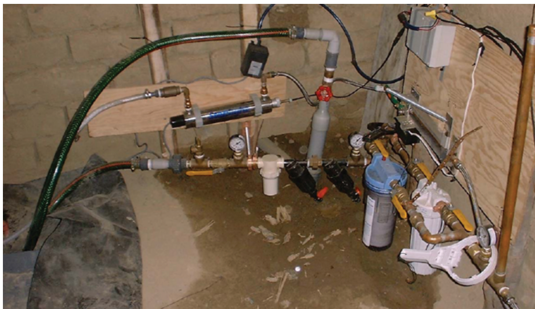
Figura 4-35: Sistema de tratamiento por rayos UV instalado por la Universidad de Lowell, Massachusetts, EEUU en Quian, Perú en 2002. El cilindro de acero inoxidable en posición horizontal es la lámpara UV. Este sistema capta agua de un manantial e incluye pre-tratamiento con coladores, filtración de sedimento en cartuchos (cilindros verticales a la derecha), y energía fotovoltaica (Hart et. al., 2003).
