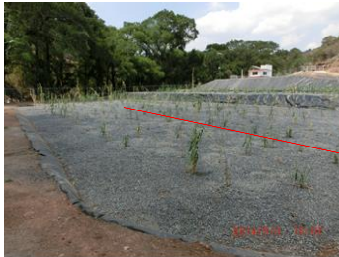
Foto 5.16 Deficiencias en la instalación de la mampara en el humedal de pulimento.
