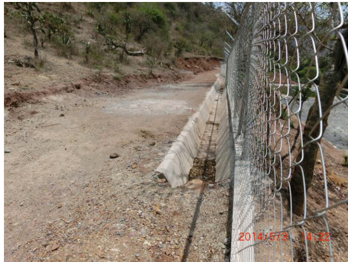
Foto 5.22 Canal para el drenado de agua de lluvia instalado para la protección del sistema de tratamiento.
