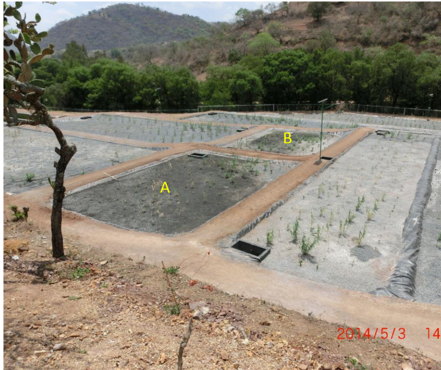
Foto 5.6 Acumulación de sólidos: humedal lodos A, humedal lodos B.
