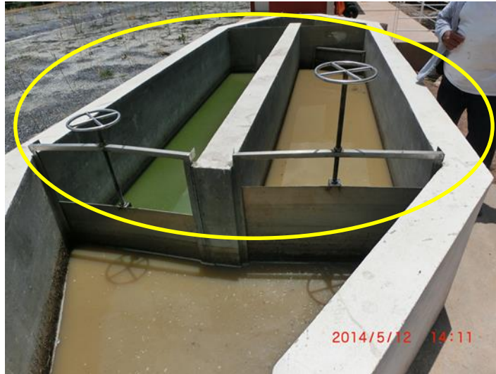
Foto 5.4 Operación incorrecta de los canales del desarenador.
