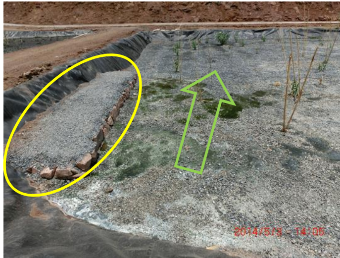
Foto 5.14 Inadecuada colocación de grava sobre los cabezales.
