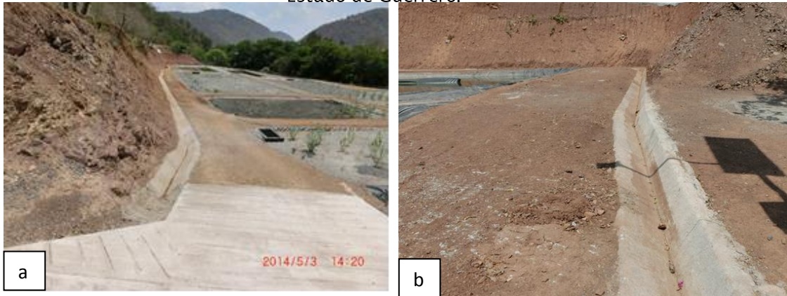
Foto 5.21 Cunetas para la protección del agua proveniente de lluvia.
