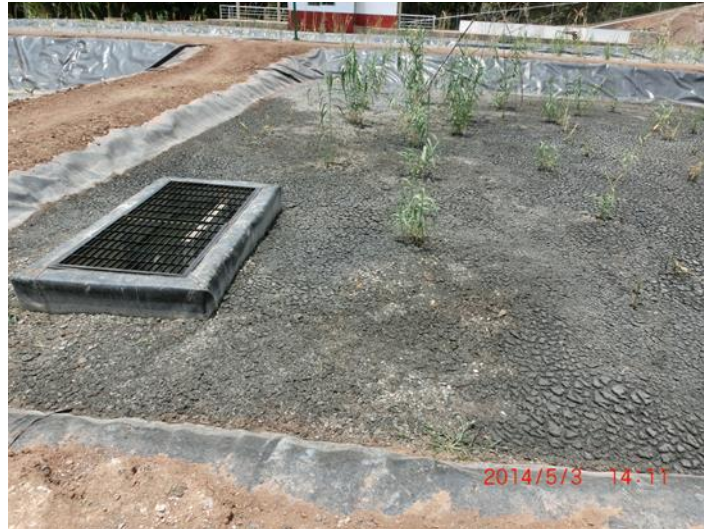
Foto 5.10 Acumulación de sólidos sobre la superficie del humedal de lodos del módulo B.
