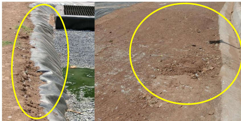
Foto 5.19 Deficiencias de los materiales de construcción.
