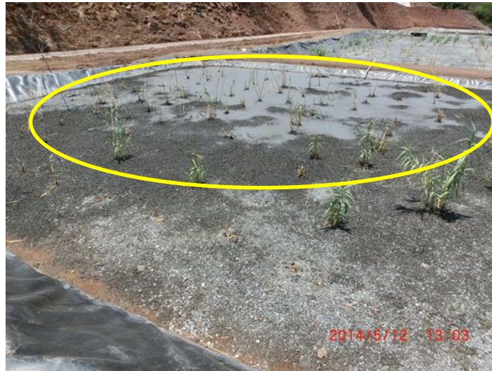
Foto 5.9 Presencia de sólidos en la superficie del humedal de lodos.
