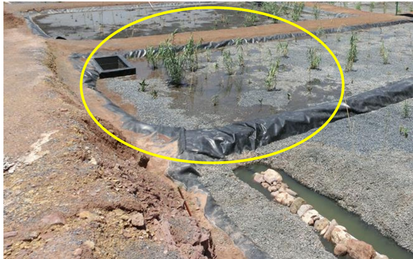
Foto 5.8 Flujo superficial del agua en el tanque del lecho orgánico del módulo B.
