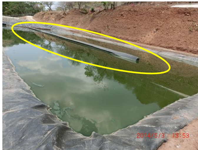
Foto 5.15 Mamparas instalada incorrectamente sobre el fondo de las lagunas.
