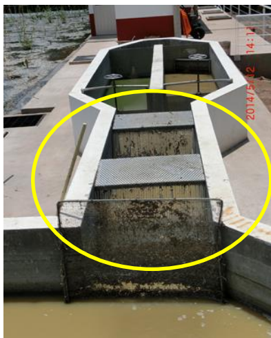
Foto 5.3 Presencia de una malla previa a las rejillas y al canal desarenador.
