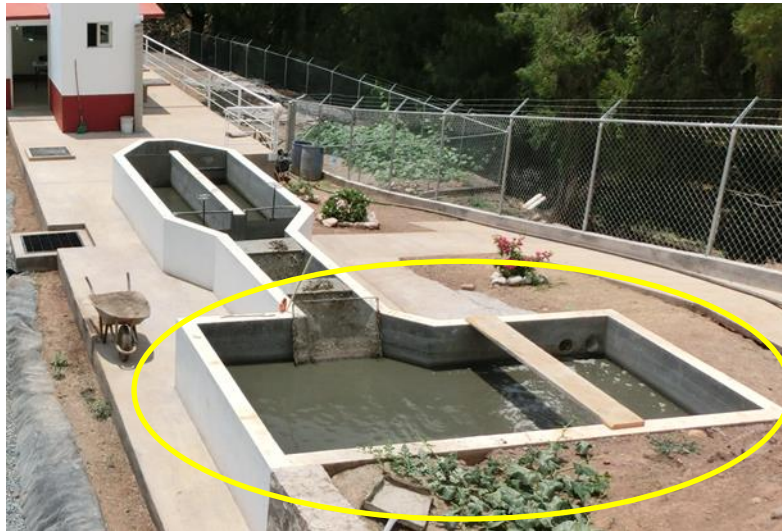
Foto 5.2 Aspecto general del tanque de homogenización.
