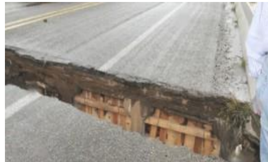
Figura 11. Separación de la superficie de rodamiento. Fuente: (Del Refugio Torrentera, 2010).
