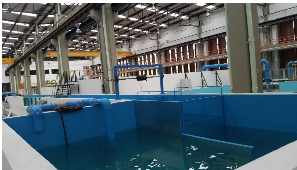
Figura 54. Tanque de almacenamiento lleno.
