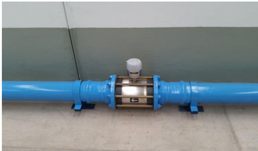
Figura 42. Medidor de flujo electromagnético.
