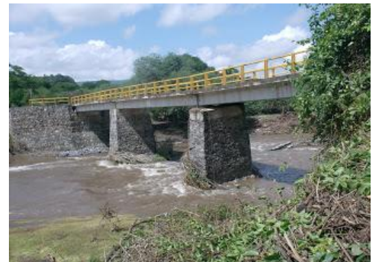
Figura 13. Falla en pila de apoyo. Fuente: (Morquecho, 2009).
