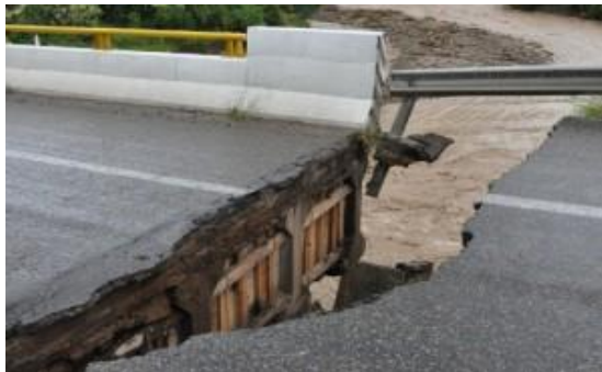
Figura 10. Separación de la superficie de rodamiento. Fuente: (Del Refugio Torrentera, 2010).
