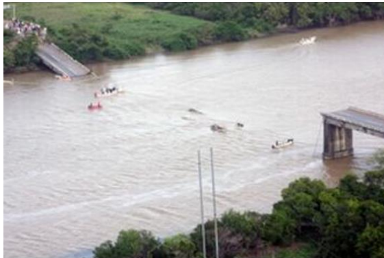
Figura 8. Colapso del puente. Fuente: (Barboza Sosa & Avila Perez, 2009).
