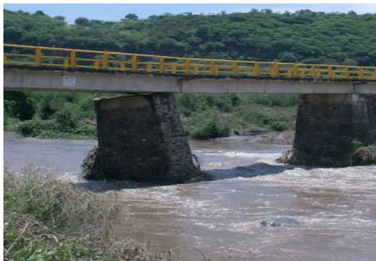
Figura 12. Falla en pila de apoyo. Fuente: (Morquecho, 2009).
