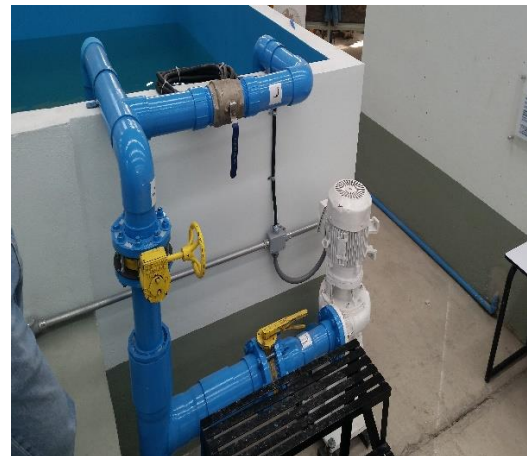
(B) Bomba centrífuga y baipás
