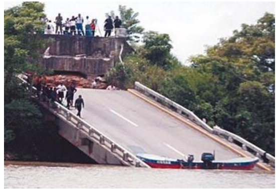
Figura 9. Colapso del puente. Fuente: (Muñoz Sánchez, 2009).
