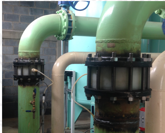
Figura 14. Mezclador estático instalado.
