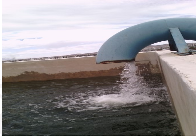
Figura 16. (DESPUÉS DEL TULE O CARRIZO), Agua recibida por gravedad en la Planta potabilizadora previo a su potabilización.
