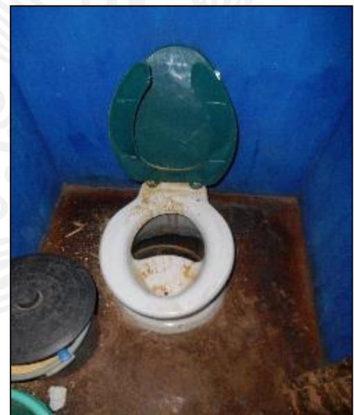
Figura28. Baño seco sin mantenimiento
