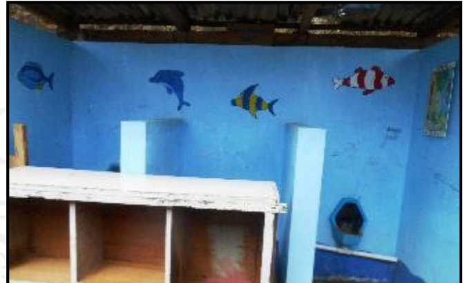
Figura24. Mingitorio sin mantenimiento
