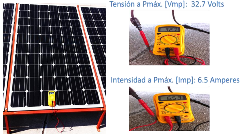
Ilustración 51. Pruebas eléctricas individuales, estas pruebas se realizaron de forma individual para cada Módulo solar LDK-240D-20
