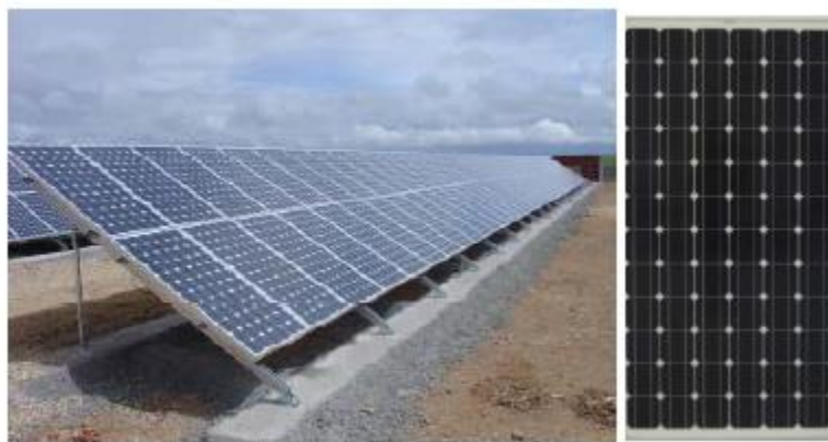
Ilustración 17. Disposición vertical de los paneles solares.
