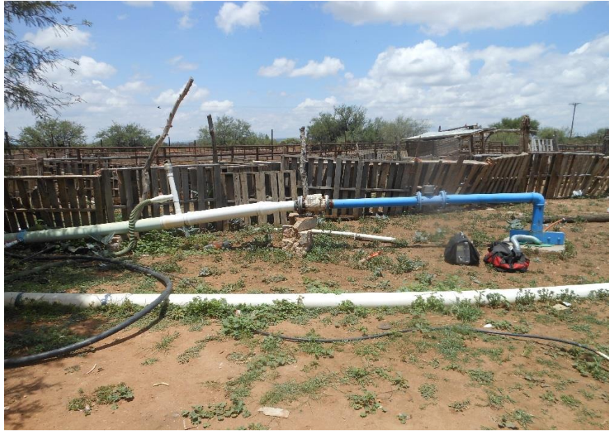
Figura 4.11. Vista del Tren de descarga del Predio Casa Blanca
