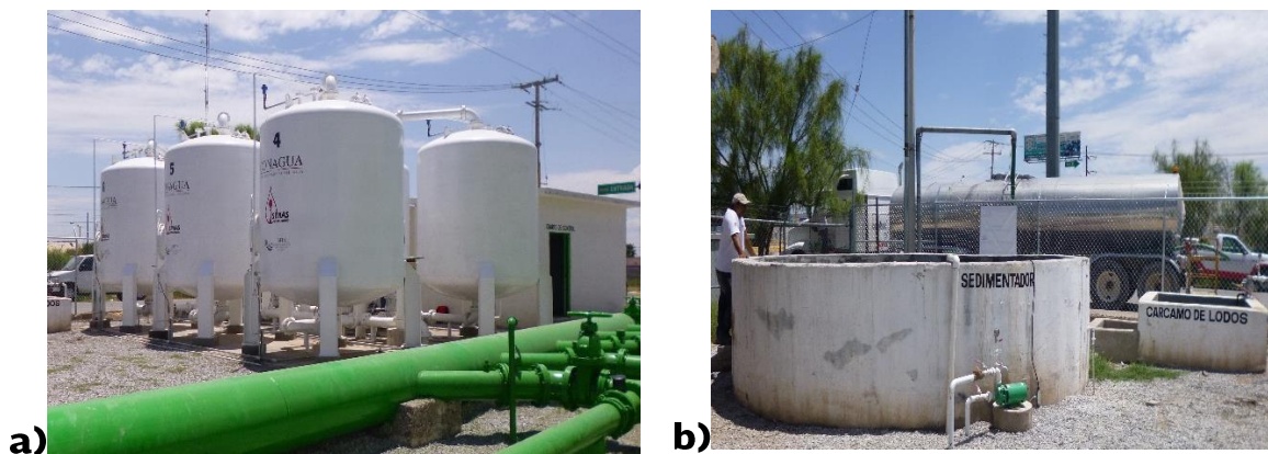
Figura 5.3-18. Sistema de filtración directa del Pozo 7 (a) y del tratamiento de lodos (b)
