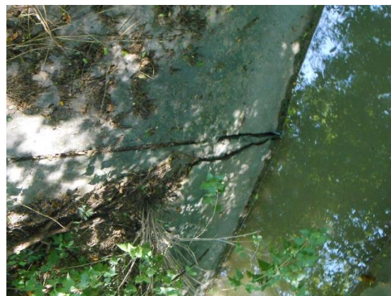
Fotografía VII.11 Grieta en el revestimiento del canal de distribución.
