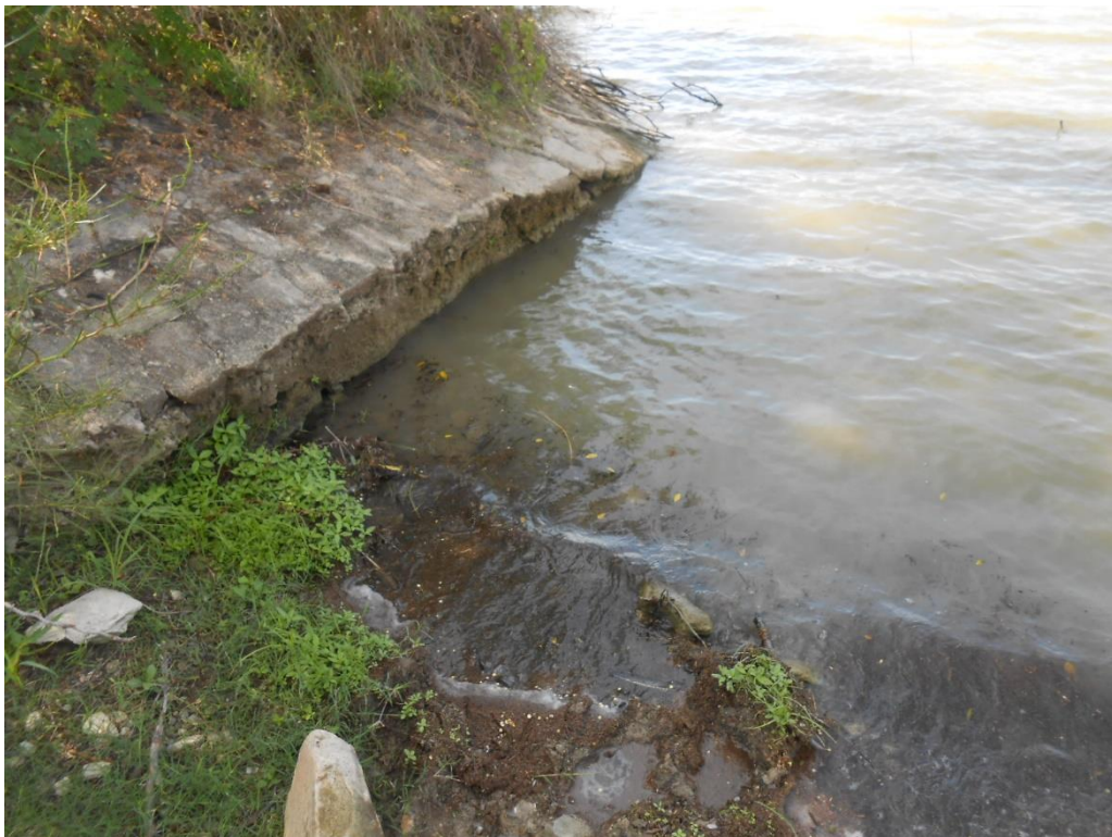
Fotografía VIII.1 Zona socavada en la base de la protección de mampostería, dentro del embalse.
