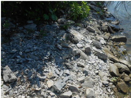
Fotografía II.20 Enrocamiento de protección desintegrado por el intemperismo.
