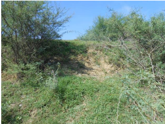
Fotografía II.26 Zona erosionada sobre el talud aguas abajo.
