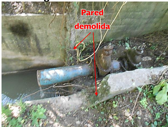
Fotografía VII.8 Tren de descarga de la obra de toma.
