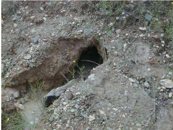
Fotografía II.32 Salida del conducto de tubificación sobre el talud aguas abajo (foto del 2001).
