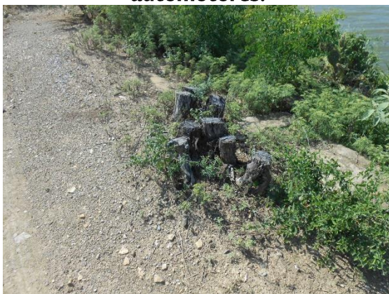
Fotografía II.14 Restos de un árbol cortado, sobre el hombro del talud aguas arriba.
