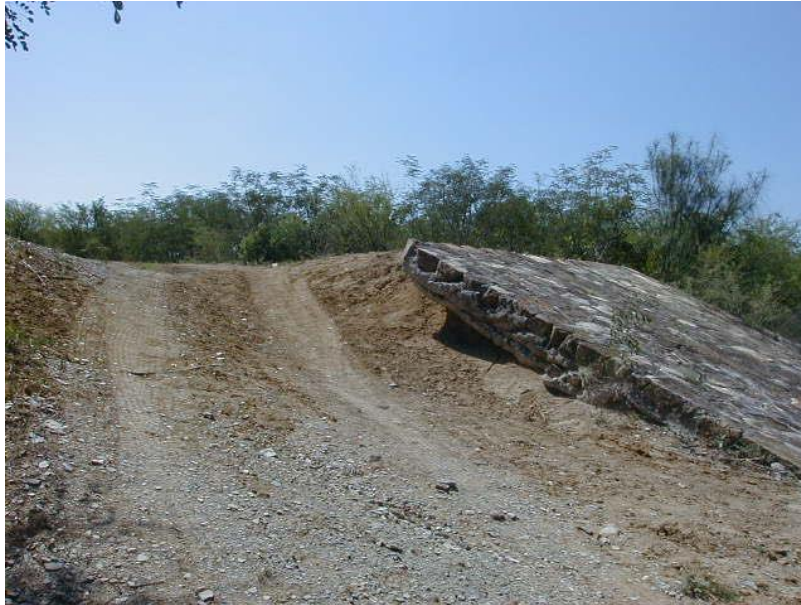
Fotografía VIII.2 Zona erosionada detrás de la chapa de protección.
