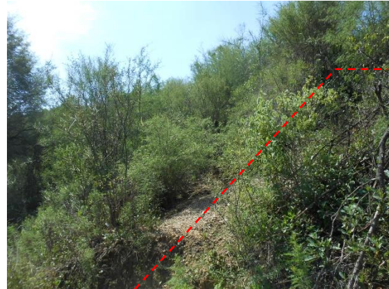
Fotografía II.23 Vegetación arbustiva sobre el talud aguas arriba en la parte central.
