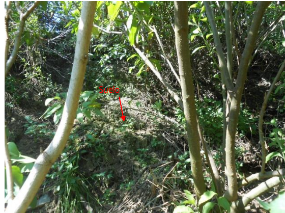
Fotografía II.37 Vista frontal de la zona reparada tomada desde el pie del talud.
