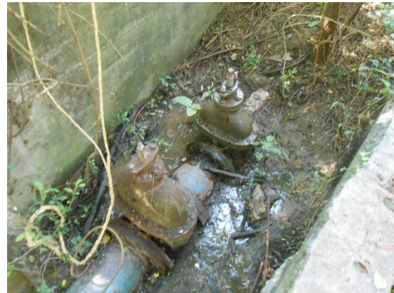
Fotografía II.56 Tren de descarga de la obra de toma.
