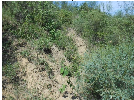
Fotografía II.29 Zona erosionada sobre el talud aguas abajo.
