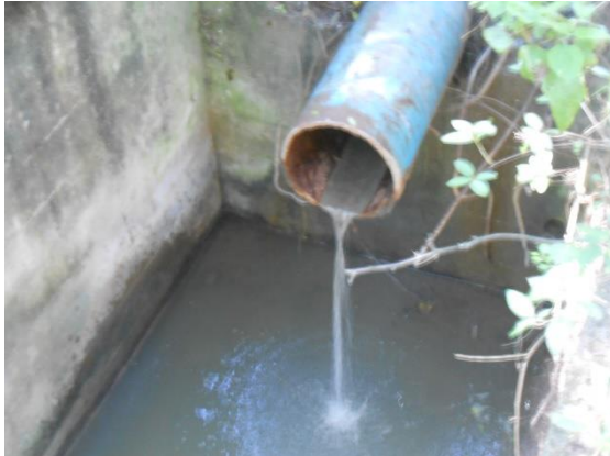
Fotografía II.59 Descarga de la obra de toma debido al deterioro de los sellos de las válvulas.
