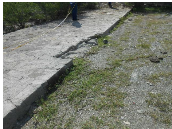
Fotografía II.42 Mampostería deteriorada de la sección de control.
