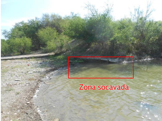
Fotografía VII.2 Socavación bajo el muro derecho del vertedor.
