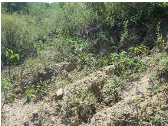
Fotografía II.28 Cárcavas de dimensiones considerables sobre el talud aguas abajo.
