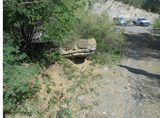
Fotografía II.31 Socavación tras la chapa de mampostería que protege a la cortina.
