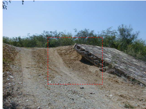
Fotografía II.48 Erosión detrás de la chapa de mampostería.
