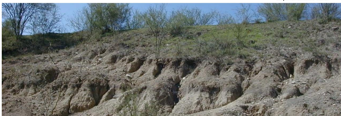
Fotografía VI.6. Daños en la cortina por erosión de lluvias.
