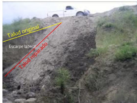
Fotografía II.35 Aspecto de la reparación de la falla sobre el talud aguas abajo (foto del 2010).
