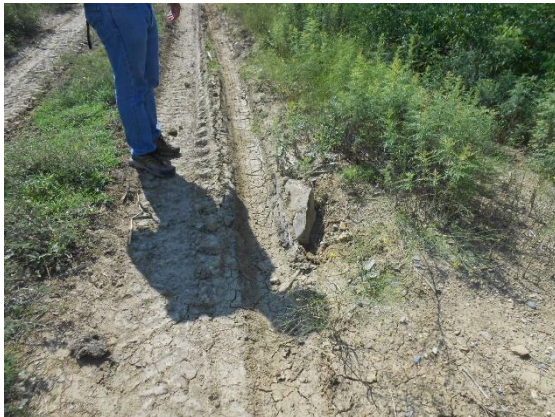
Fotografía II.12 Deformaciones de la corona por el paso de vehículos automotores.
