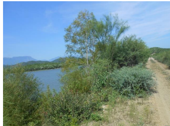
Fotografía II.21 Arbustos y árboles jóvenes sobre el talud aguas arriba.
