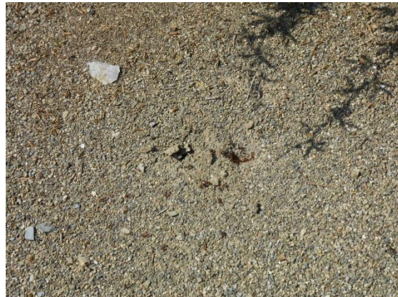
Fotografía II.13 Presencia de hormigueros sobre la corona.
