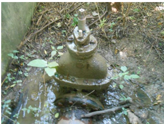
Fotografía II.57 Válvula de emergencia, tipo compuerta, de 0.25 m de diámetro
