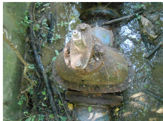
Fotografía II.58 Válvula de servicio, tipo compuerta, de 0.31 m de diámetro
