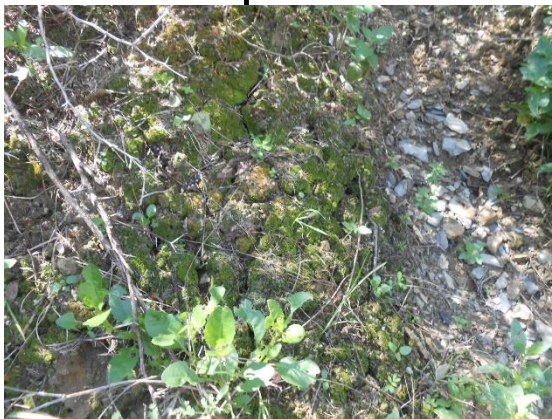
Fotografía II.38 Detalle del suelo húmedo sobre el talud en la zona reparada.
