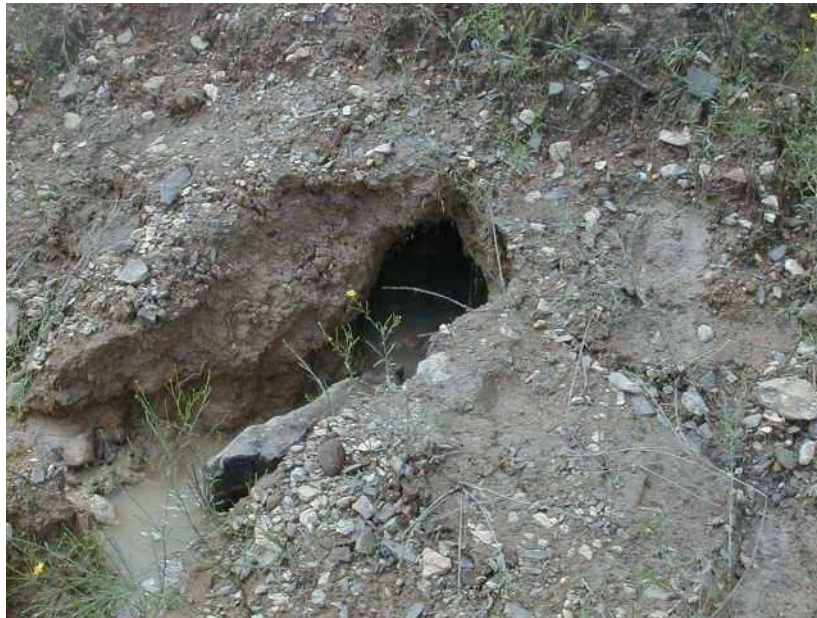
Fotografía VI.11 Orificio con filtración al pie del talud aguas abajo en 2011.
