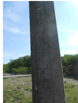
Fotografía II.52 Datos del poste de la CFE (CFE-11-700-1970P).
