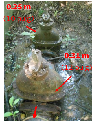
Fotografía VII.9 Válvulas de mariposa de la obra de toma.
