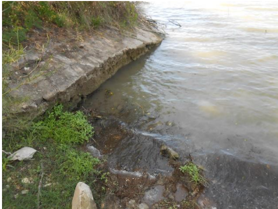
Fotografía II.47 Socavación en la zona aguas arriba de la sección de control.
