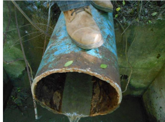
Fotografía II.60 Detalle del tubo de descarga, con rasgos de oxidación.
