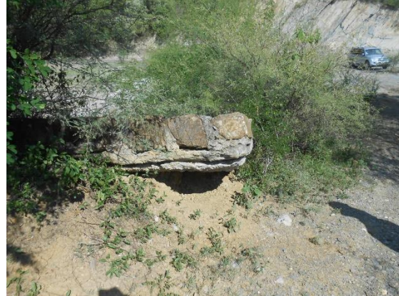
Fotografía VII.3 Erosión detrás del muro sobre el talud aguas abajo.
