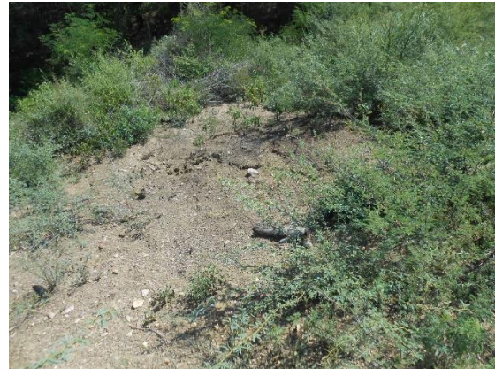
Fotografía II.27 Surcos de erosión por escurrimientos sobre el talud aguas abajo.
