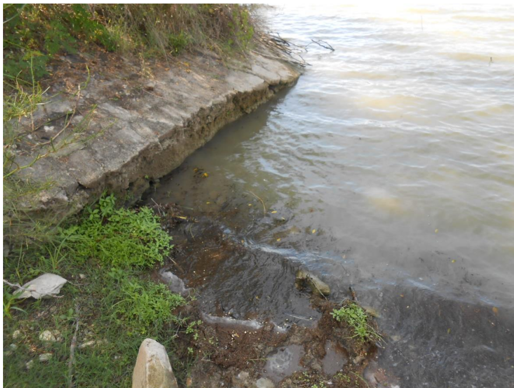
Fotografía 1.1 Zona socavada en la base de la protección de mampostería, dentro del embalse.
