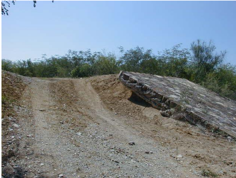
Fotografía 1.2 Zona erosionada detrás de la chapa de protección.
