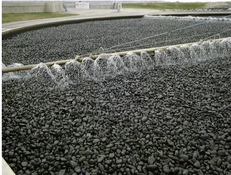
Fig. 6.11 Filtro rociador operando.
