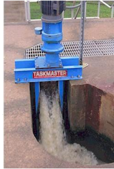
Fig. 2.5 Desmenuzador instalado en un canal.
