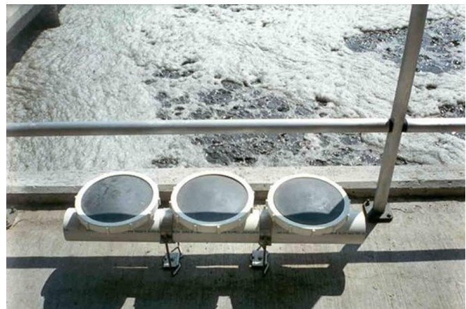
Fig. 5.74 Digester aerobio de lodos con discos difusores.
