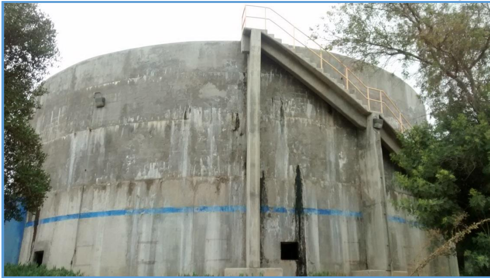
Figura 9. Filtro percolador #1 donde se observa la poca ventilación
