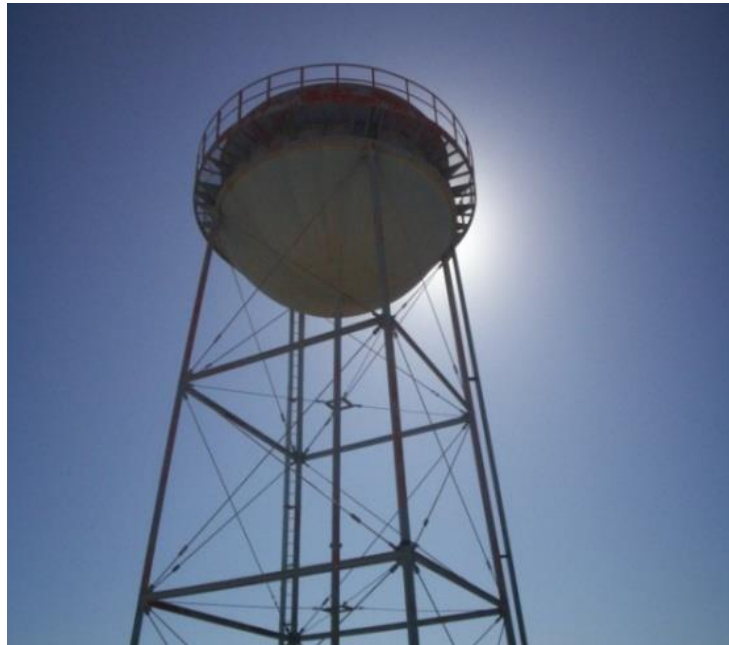
Ilustración 3-48 Tanque elevado metálico con capacidad de 200 m 3 para abastecer Bermejillo
