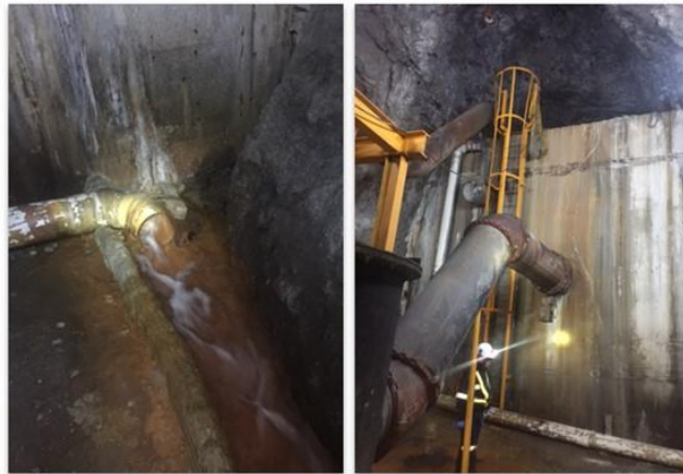
Ilustración 2-3 Sistema de bombeo al interior de la mina.
