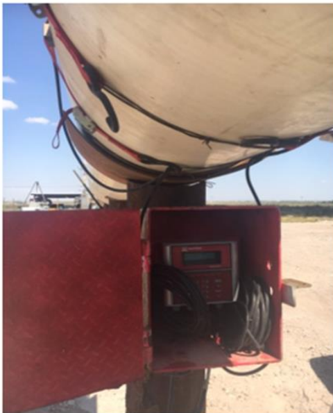
Ilustración 2-10 Medidor de flujo de la pileta “Guadalupe Sur”.
