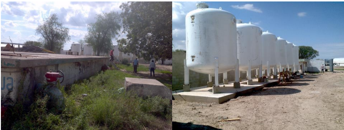
Ilustración 3-73 Tanque “El Lucero” y su infraestructura de filtros para mejora de la calidad del agua
