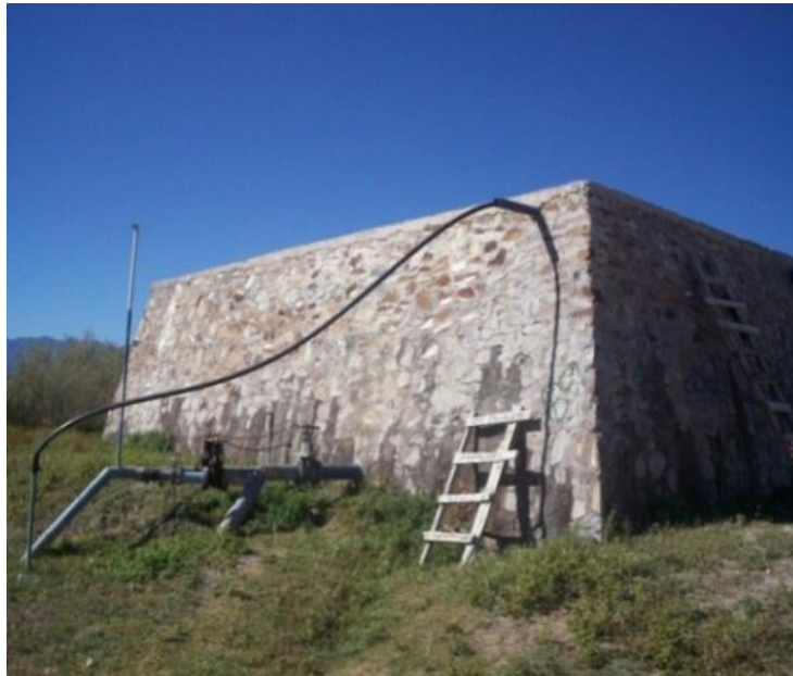
Ilustración 3-47 Tanque de mampostería con capacidad de 1000 m 3 para abastecer Mapimí Fuente: Elaboración propia
