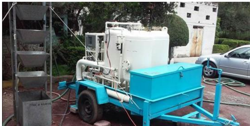
Figura 4-1 Instalación de aireador de charolas y planta piloto con filtros de zeolita clinoptilolita virgen y recubierta de óxidos de manganeso, en el Vivero Netzahualcóyotl (Ramal Tláhuac).
