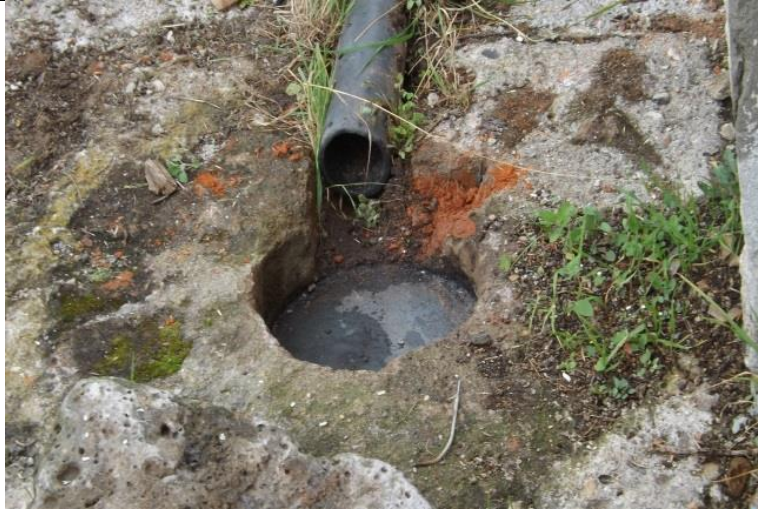
(a) Pozo las Lajas sin clausurar
