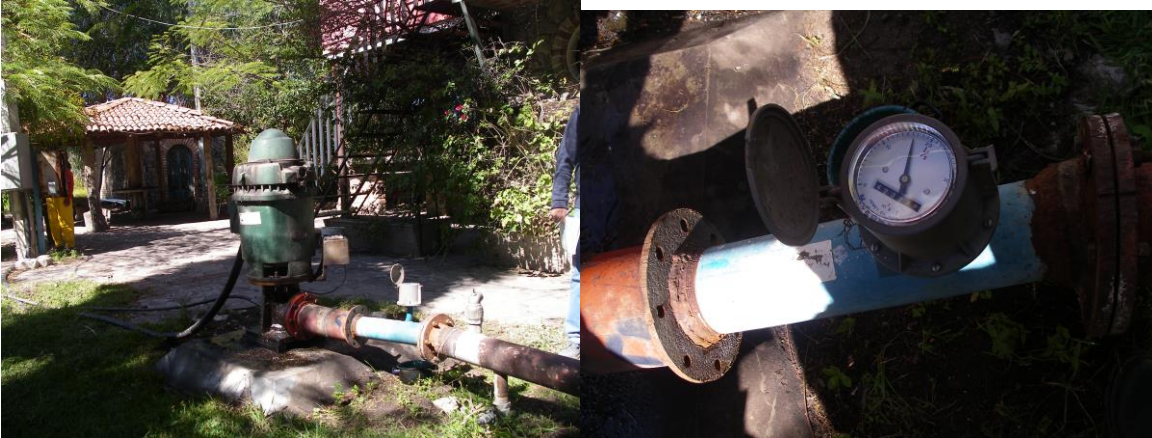
Fotos 4.4.4 y 4.4.5 Ubicación del pozo y la lectura de medidor volumétrico, respectivamente
