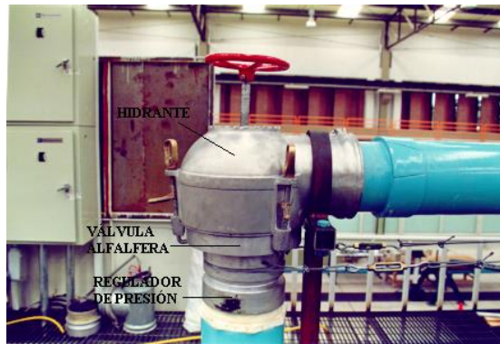
Foto A1.2 Instalación típica de campo.
