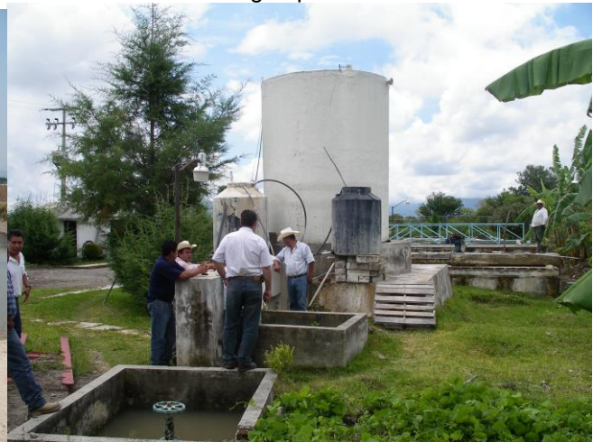
Foto 1.4. Planta de agua potable.
