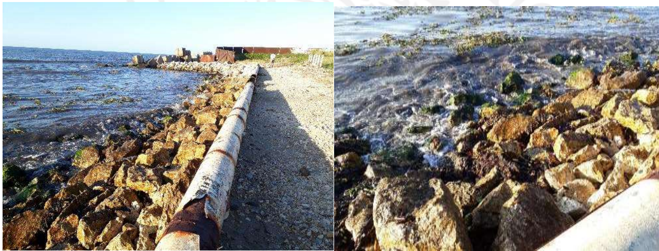
Figura 16. Estructuras de protección Campo Tizón Tabasco, 2017.
