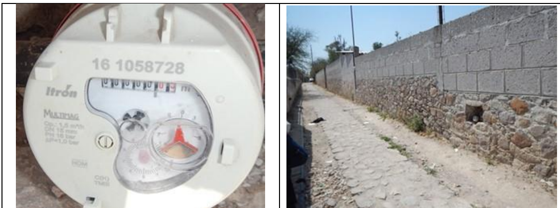
Figura 12. Medidor Itrón, Multimag 161058728, clase C, sin VAF. Detalles de medidor con número de serie. Comunidad Zamorano, municipio de Colón. Lectura del medidor: 0.05 m3. El medidor no tiene tapa.
