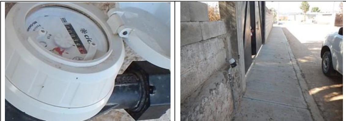
Figura 29. Medidor CICASA, MS Delaunet 17270969, clase B, con VAF1. Detalles de medidor con número de serie. Comunidad Viborillas, municipio de Colón. Lectura del medidor: 39.31 m3.
