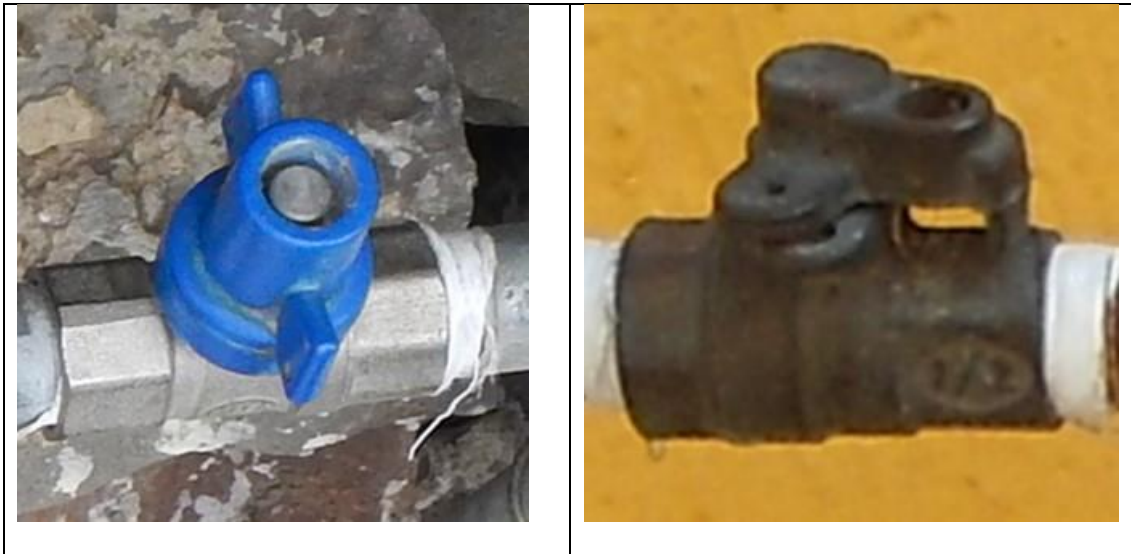
Ilustración 6. Izquierda: tipo de válvula antifraude (VAF) que en algunos tomas se instalaron junto con la instalación o sustitución de medidores como parte del Proyecto Ejecutivo de modernización comercial. Derecha: tipo de (VAF), vieja, encontrada en algunas de las tomas de la muestra, existente antes de la instalación o sustitución del medidor.
