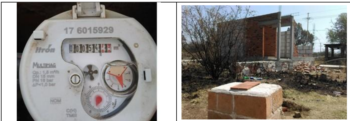
Figura 15. Medidor Itrón, Multimag 176015929, clase C, sin VAF. Detalles de medidor con número de serie. Comunidad La Esperanza, municipio de Colón. Lectura del medidor: 54.794 m 3 . El medidor está instalado dentro de un cajón, pero se tiene acceso a él. El predio está en construcción.
