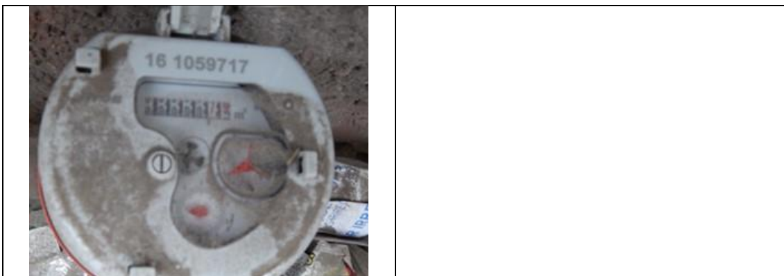
Figura 30. Medidor Itron, Multimag 161059717 clase C, sin VAF Detalles de medidor con número de serie. Comunidad Vista Hermosa, municipio de Colón. Lectura del medidor: 0.79 m3. La casa está deshabitada y el medidor está instalado dentro de un cajón.
