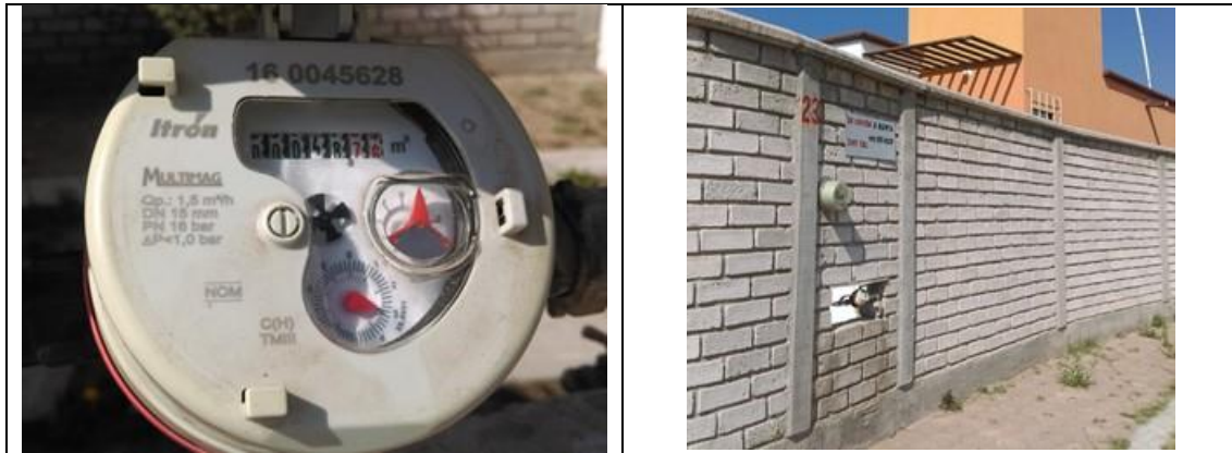
Figura 19. Medidor Itron, Multimag 160045628, clase B, sin VAF. Detalles de medidor con número de serie. Comunidad Los Naranjos, municipio de Colón. Lectura del medidor: 48.760 m3.
