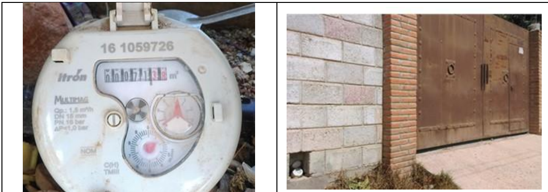
Figura 14. Medidor Itrón, Multimag 161059726, clase C, sin VAF. Detalles de medidor con número de serie. Comunidad La Esperanza, municipio de Colón. Lectura del medidor: 71.378 m 3 . El medidor y Columpio están instalados a nivel del piso del interior de la casa.
