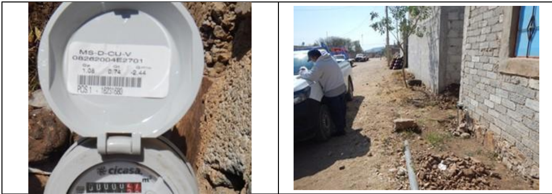
Figura 16. Medidor CICASA, MS Delaunet 16231680, clase B, con VAF1. Detalles de medidor con número de serie. Comunidad La Peñuela, municipio de Colón. Lectura del medidor: 0.27 m 3 .
