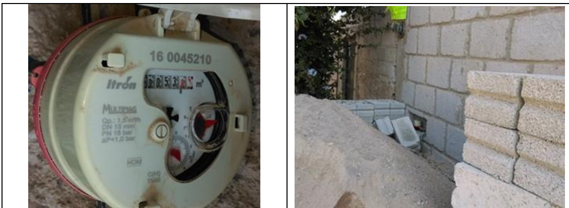
Figura 8. Medidor Itron, Multimag 160045210, clase C, sin VAF. Detalles de medidor con número de serie. Comunidad El Lindero, municipio de Colón. Lectura del medidor: 53.842 m3.
