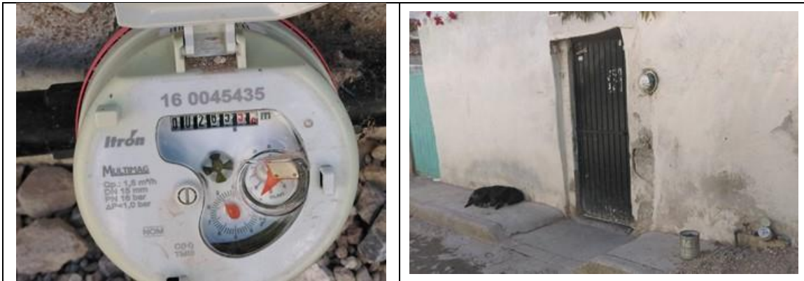
Figura 1. Medidor Itron, Multimag 160045435 clase C, sin VAF. Detalles de medidor con número de serie. Barrio Ajuchitlán, municipio de Colón. Lectura del medidor: 265.556 m 3 .
