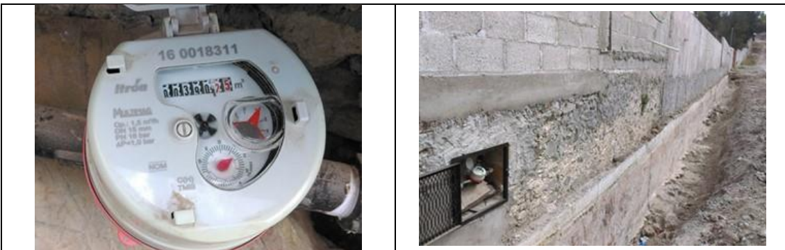
Figura 24. Medidor Itrón, Multimag 160018311, clase C, sin VAF. Detalles de medidor con número de serie. Comunidad San Antonio de la Cal, municipio de Colón. Lectura del medidor: 390.250 m3.
