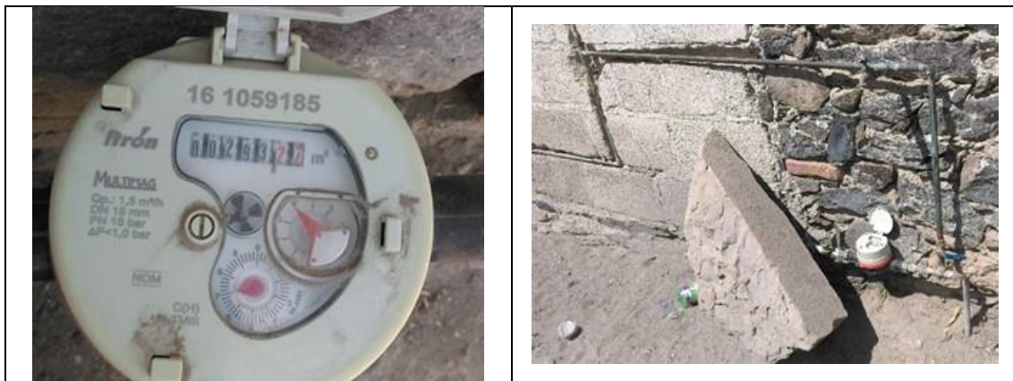
Figura 26. Medidor Itrón, Multimag 161059185, clase C, con VAF1. Detalles de medidor con número de serie. Comunidad Santa Rosa Finca, municipio de Colón. Lectura del medidor: 293.239 m 3 .
