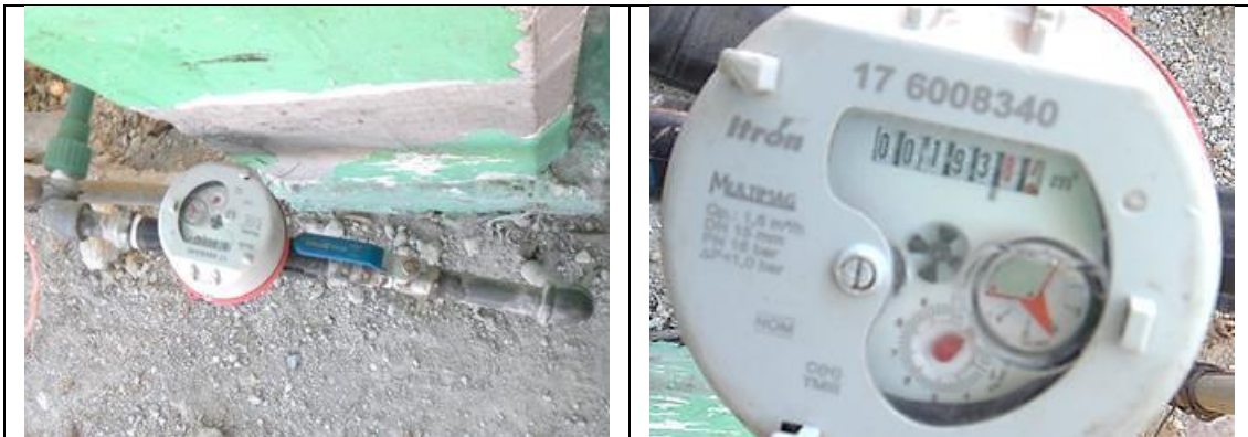
Figura 5. Medidor Itrón, Multimag 176008340, clase C, sin VAF. Cuadro de toma y detalle de medidor con número de serie. Comunidad Chichimequillas, municipio de El Marqués. Lectura del medidor: 193.87 m 3 . Se encontró que el medidor no cuenta ya con tapa para la carátula. Atendió la hija del usuario titular.
