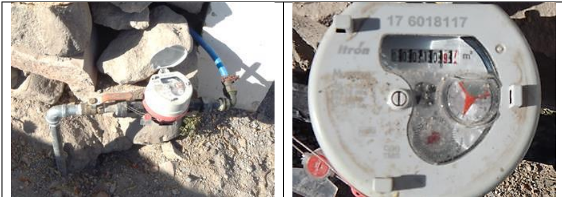
Figura 28. Medidor Itrón, Multimag 176018117, clase C, sin VAF. Cuadro de toma y detalle de medidor con número de serie. Comunidad Santa María de los Baños, municipio de El Marqués. Lectura del medidor: 10.97 m 3 . Atendió usuaria titular.
