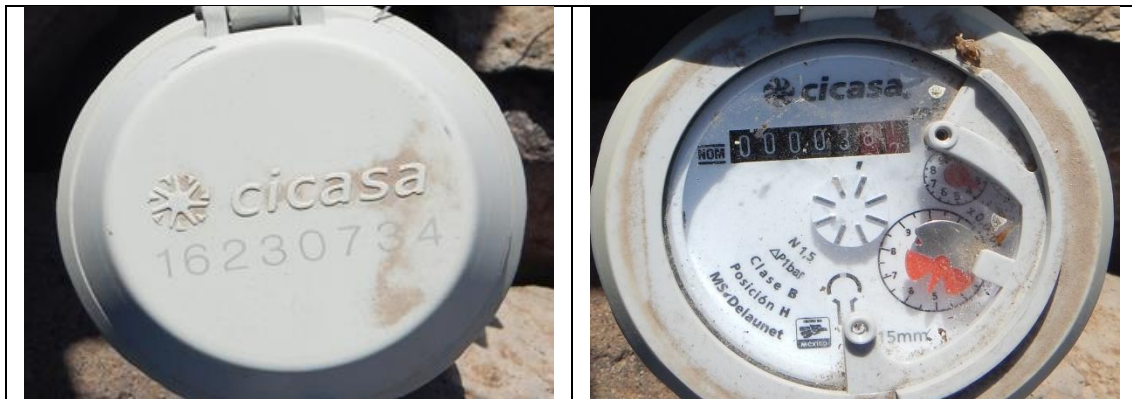
Figura 13. Medidor CICASA, MS Delaunet 16230734, clase B, con VAF2. Detalles de medidor con número de serie. Comunidad Los Pocitos, municipio de El Marqués. Lectura del medidor: 3.84 m 3 . Se encontró que debe corregirse el modelo (es MS-Delaunet, no Aquarius ½), en el padrón de usuarios. No se encontró a ninguna persona en el domicilio.
