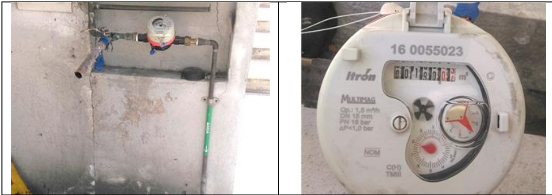
Figura 30. Medidor Itrón, Multimag 160055023, clase C, sin VAF. Cuadro de toma y detalle de medidor con número de serie. Fraccionamiento Parque Industrial Bernardo Quintana, municipio de El Marqués. Lectura del medidor: 190.03 m 3 . No se encontró a ninguna persona en el domicilio.
