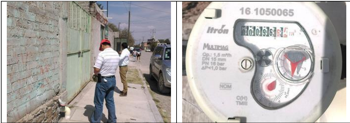
Figura 16. Medidor Itron, Multimag 161050065, clase C, sin VAF. Frente del predio y detalle de medidor con número de serie. Colonia San Isidro Miranda, municipio de El Marqués. Lectura del medidor: 96.67 m 3 . No se encontró a ninguna persona en el domicilio.
