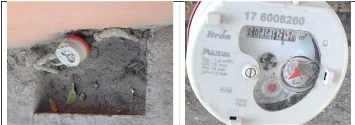
Figura 4. Medidor Itrón, Multimag 176008260, clase C, sin VAF. Cuadro de toma y detalle de medidor con número de serie. Comunidad Chichimequillas, municipio de El Marqués. Lectura del medidor: 112.46 m 3 . Se encontró que el medidor no cuenta ya con tapa para la carátula. No se encontró a ninguna persona en el domicilio.
