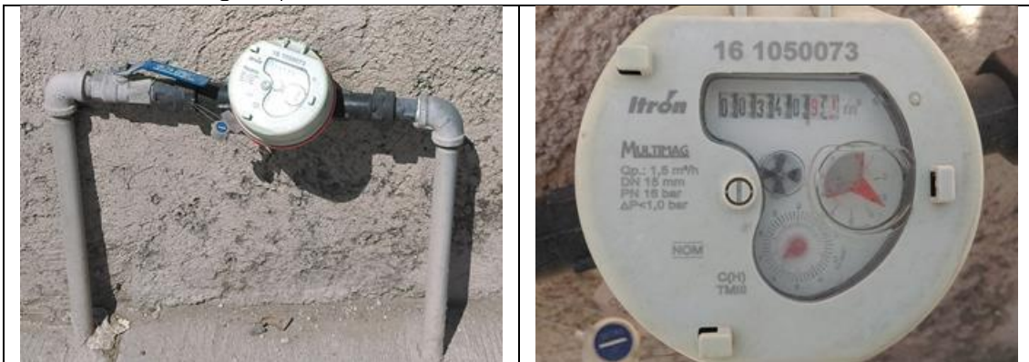
Figura 20. Medidor Itron, Multimag 161050073, clase C, sin VAF. Cuadro de toma y detalle de medidor con número de serie. Colonia San Isidro Miranda, municipio de El Marqués. Lectura del medidor: 340.91 m 3 . Se encontró que el medidor no cuenta ya con tapa para la carátula. Debe registrarse el número de predio (es 311) en el padrón de usuarios. Atendió inquilino del usuario titular.
