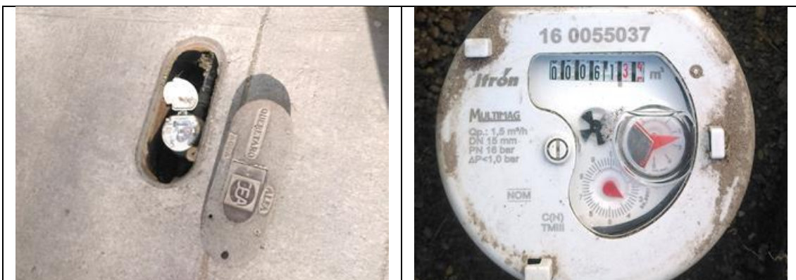
Figura 29. Medidor Itrón, Multimag 160055037, clase C, con VAF2. Registro de toma y detalle de medidor con número de serie. Fraccionamiento Hacienda de la Cruz, municipio de El Marqués. Lectura del medidor: 61.34 m 3 . Se encontró que se debe corregir la marca del medidor (es Itrón, no Cicasa) y el modelo (es Multimag, no Aquarius ½), en el padrón de usuarios. Atendió inquilino de la usuaria titular.
