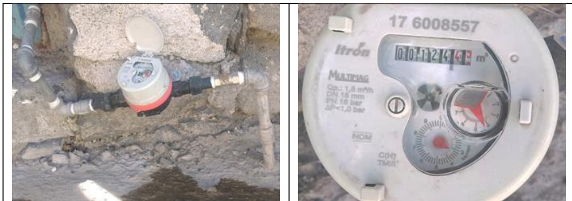
Figura 8. Medidor Itrón, Multimag 176008557, clase C, sin VAF. Cuadro de toma y detalle de medidor con número de serie. Comunidad El Colorado, municipio de El Marqués. Lectura del medidor: 124.45 m 3 . Atendió usuaria titular.
