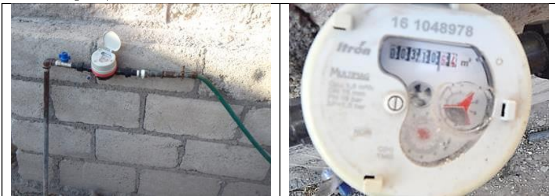
Figura 25. Medidor Itrón, Multimag 161048978, clase C, con VAF1. Cuadro de toma y detalle de medidor con número de serie. Comunidad Santa Cruz Forrajes, municipio de El Marqués. Lectura del medidor: 310.64 m 3 . No se encontró a ninguna persona en el domicilio.
