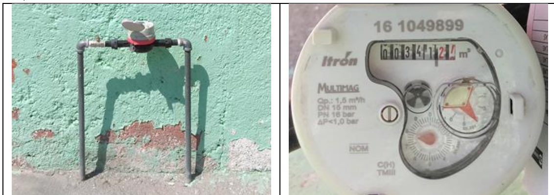
Figura 14. Medidor Itrón, Multimag 161049899, clase C, sin VAF. Cuadro de toma y detalle de medidor con número de serie. Colonia San Isidro Miranda, municipio de El Marqués. Lectura del medidor: 341.27 m 3 . No se encontró a ninguna persona en el domicilio.
