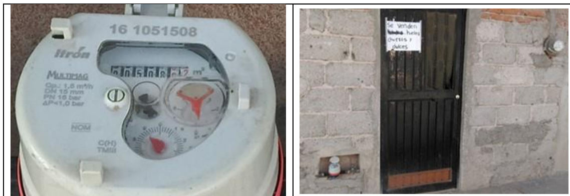
Figura 26. Medidor Itrón, Multimag 161051508, clase C, sin VAF. Detalles de medidor con número de serie. Colonia La Presa, municipio de Ezequiel Montes. Lectura del medidor: 508.625 m 3 .
