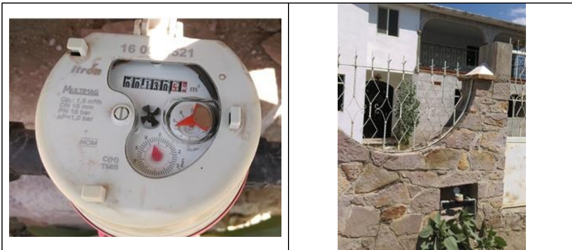
Figura 30. Medidor Itron, Multimag 160025521 clase C, sin VAF. Detalles de medidor con número de serie. Comunidad El Ciervo, municipio de Ezequiel Montes. Lectura del medidor: 130.587 m 3 . En la base de datos la marca del medidor está como CICASA pero en realidad es Itron, se corrigió esto en la base de datos.
