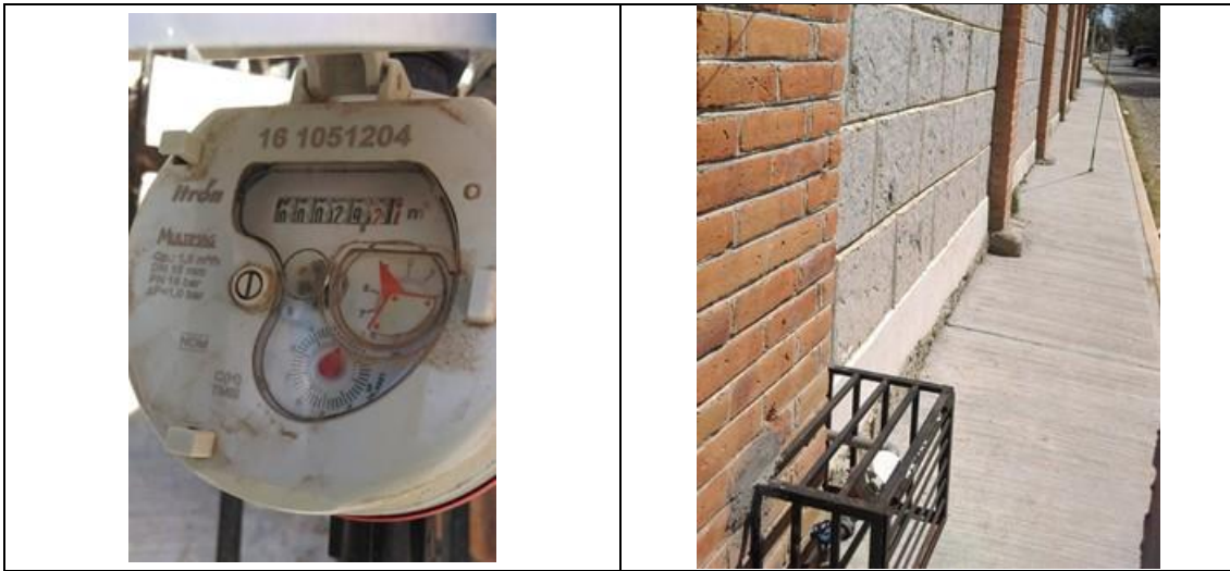
Figura 1. Medidor Itron, Multimag 161051204 clase C, sin VAF. Detalles de medidor con número de serie. Barrio Los Velázquez, municipio de Ezequiel Montes. Lectura del medidor: 29.239 m 3 .
