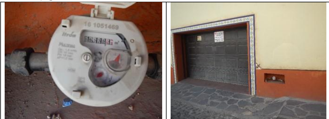
Figura 8. Medidor Itrón, Multimag 161051469, clase C, sin VAF. Detalles de medidor con número de serie. Colonia Bernal, municipio de Ezequiel Montes. Lectura del medidor: 270.43 m 3 .
