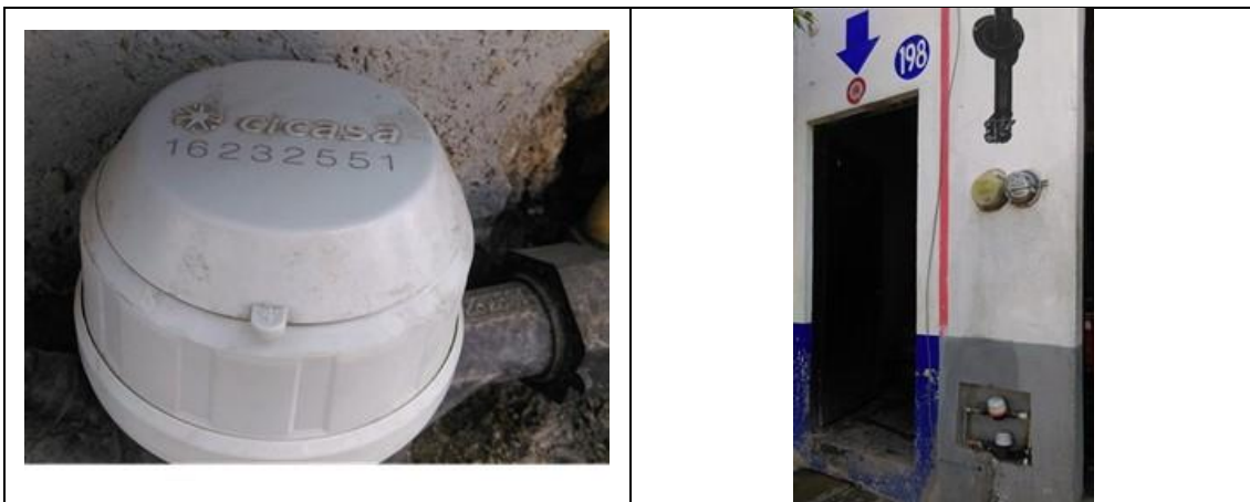
Figura 19. Medidor CICASA, MS Delaunet 16232551, clase B, sin VAF. Detalles de medidor con número de serie. Colonia Centro, municipio de Ezequiel Montes. Lectura del medidor: 106.870 m 3 . Aparente fuga en el codo que conecta el cuadro con la tubería que ingresa al predio. La casa tiene marcado el No. 198 y la base de datos no tiene número, por lo cual es recomendable actualizar la base de datos del Padrón de usuarios.
