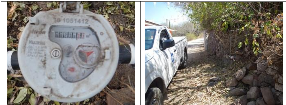
Figura 5. Medidor Itrón, Multimag 161051412, clase C, sin VAF. Detalles de medidor con número de serie. Barrio Sta Maria, Villa Progreso, municipio de Ezequiel Montes. Lectura del medidor: 238.37 m 3 . Predio Deshabitado.
