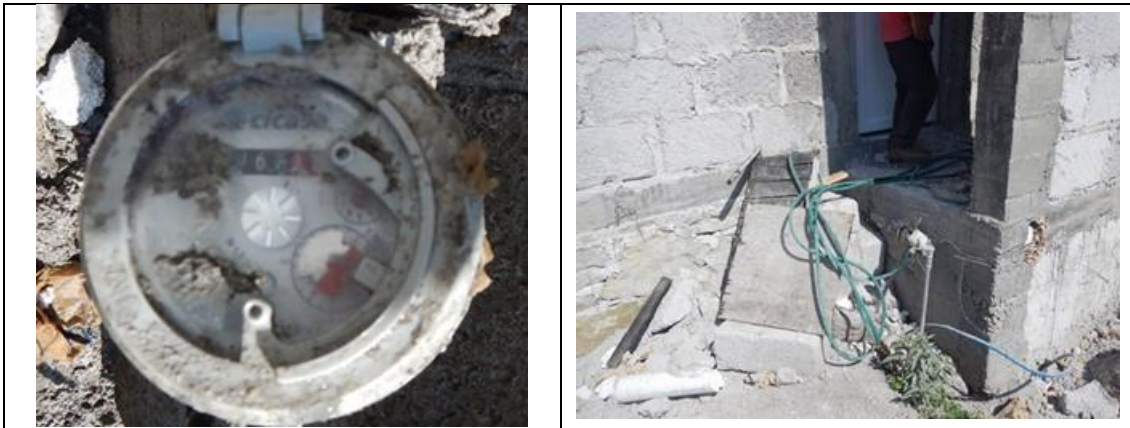
Figura 7. Medidor CICASA, MS Delaunet 16232520, clase B, con VAF2. Detalles de medidor con número de serie. Colonia Bernal, municipio de Ezequiel Montes. Lectura del medidor: 67.18 m 3 . El medidor tiene mucho mortero pegado.
