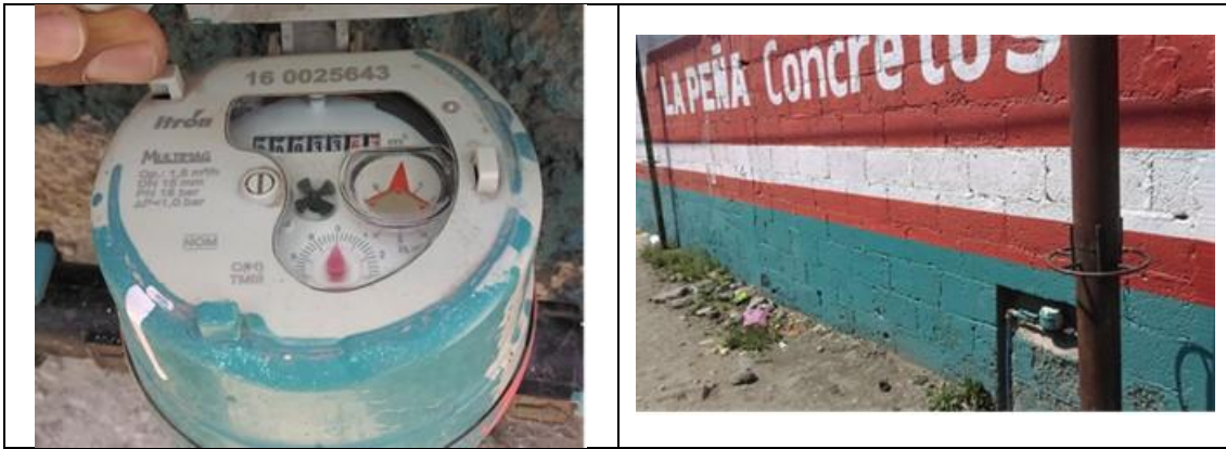
Figura 23. Medidor Itrón, Multimag 160025643, clase C, sin VAF. Detalles de medidor con número de serie. Colonia Centro, municipio de Ezequiel Montes. Lectura del medidor: 33.670 m 3 . El cuadro está muy flojo, parte del medidor pintado con la pintura del muro. En la base de datos la marca del medidor está como CICASA pero en realidad es Itrón, se corrigió esto en la base de datos.
