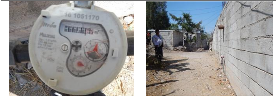
Figura 4. Medidor Itrón, Multimag 161051170, clase C, sin VAF. Detalles de medidor con número de serie. Barrio San Miguel, Villa Progreso, municipio de Ezequiel Montes. Lectura del medidor: 10.35 m 3 .
