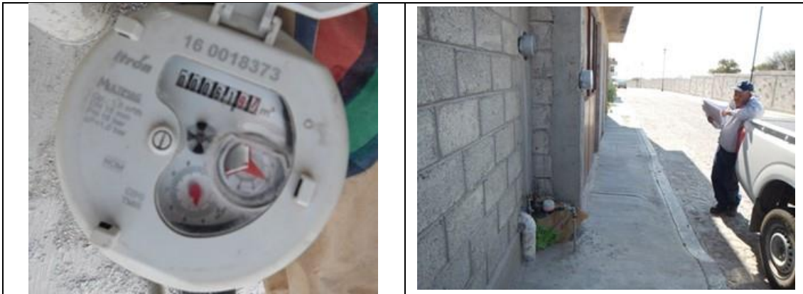
Figura 10. Medidor Itrón, Multimag 160018373, clase C, con VAF2 . Detalles de medidor con número de serie. Colonia Bernal, municipio de Ezequiel Montes. Lectura del medidor: 61.97 m 3 .
