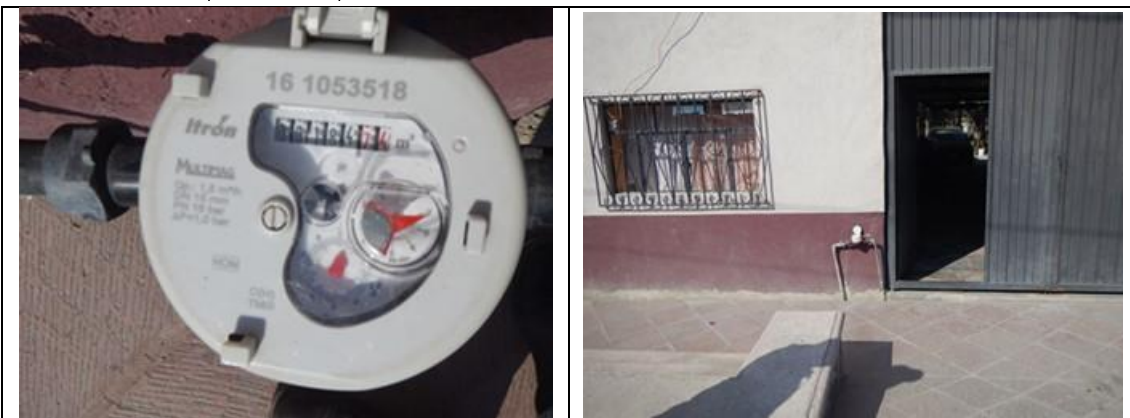
Figura 9. Medidor Itrón, Multimag 161053518, clase C, con VAF1 . Detalles de medidor con número de serie. Colonia Bernal, municipio de Ezequiel Montes. Lectura del medidor: 184.74 m 3 .
