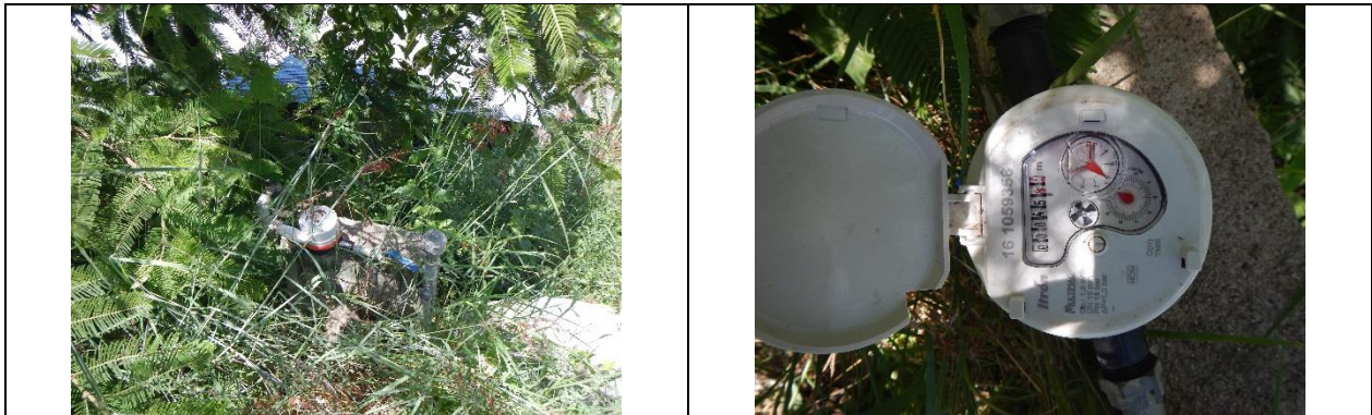
Figura 16. Medidor buscado 161059356, Clase C. Predio con toma y detalle de medidor con número de serie. Sin VAF. Colonia Buenos Aires, comunidad de Jalpan de Serra. Lectura del medidor: 45.88 m 3 .
