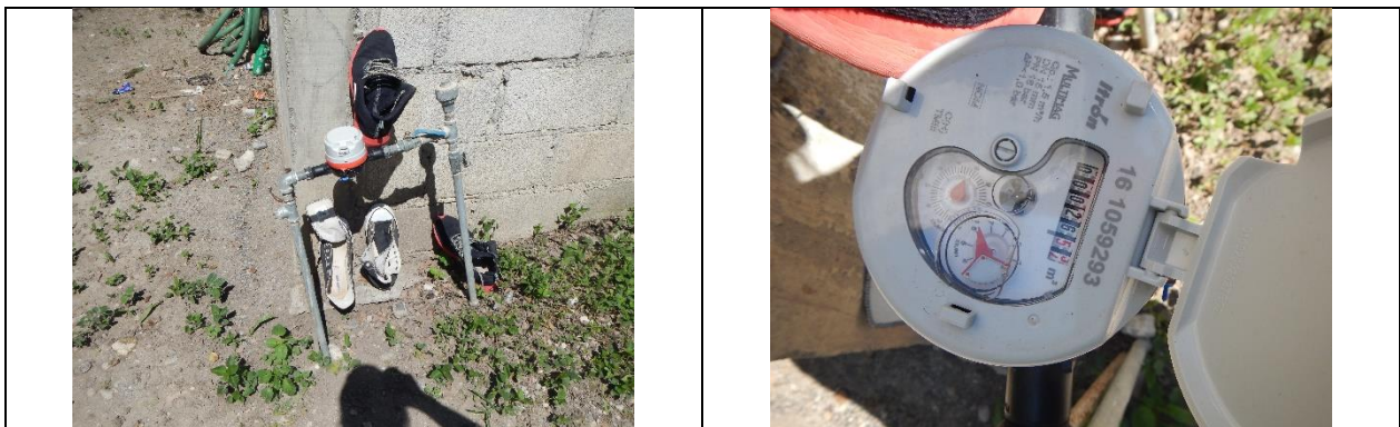
Figura 25. Medidor 161059293, Clase C. Predio con toma y detalle de medidor con número de serie. Sin VAF. Localidad El Lindero, municipio de Jalpan de Serra. Lectura del medidor: 26.53 m 3 . Se encontró que el modelo de medidor no corresponde al registrado en el padrón de usuarios de la CEA.
