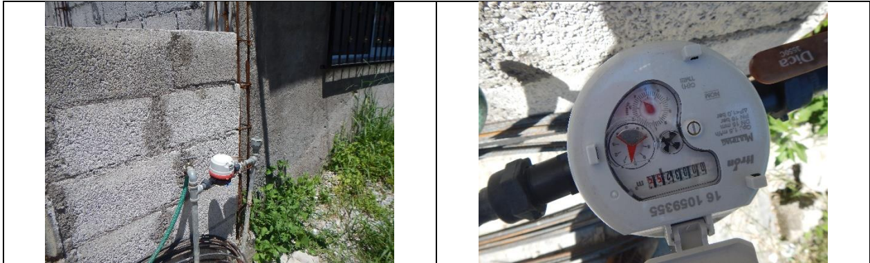
Figura 15. Medidor 161059355, Clase C. Predio con toma y detalle de medidor con número de serie. Sin VAF. Colonia Buenos Aires, comunidad de Jalpan de Serra. Lectura del medidor: 32.55 m 3 .
