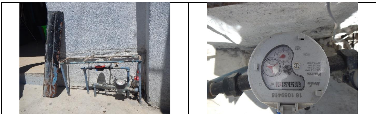
Figura 19. Medidor 161059418, clase C. Sin VAF. Colonia Centro, comunidad de Jalpan de Serra. Lectura del medidor: 52.31 m 3 . Se encontró que la marca, modelo y demás características (clase) del medidor no corresponde al registrado en el padrón de usuarios de la CEA.
