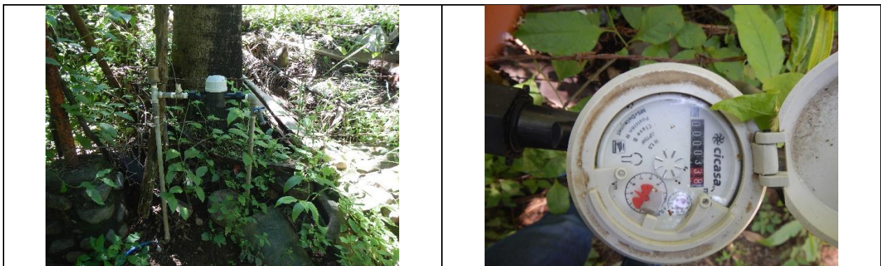
Figura 13. Medidor buscado 16230845, Clase B. Predio con toma y detalle de medidor con número de serie. Con VAF. Barrio Las Ortigas, comunidad de Jalpan de Serra. Lectura del medidor: 3.38 m 3 . Se encontró que el modelo de medidor no corresponde al registrado en el padrón de usuarios de la CEA.
