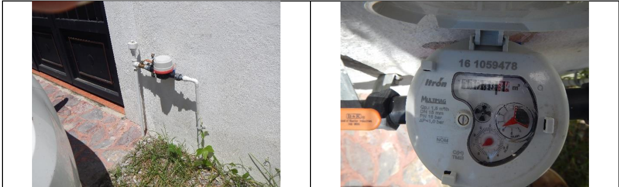
Figura 18. Medidor 161059478, Clase C. Sin VAF. Colonia Centro, comunidad de Jalpan de Serra. Lectura del medidor: 83.67 m 3 . Se encontró que la marca, modelo y demás características (clase) del medidor no corresponde al registrado en el padrón de usuarios de la CEA.
