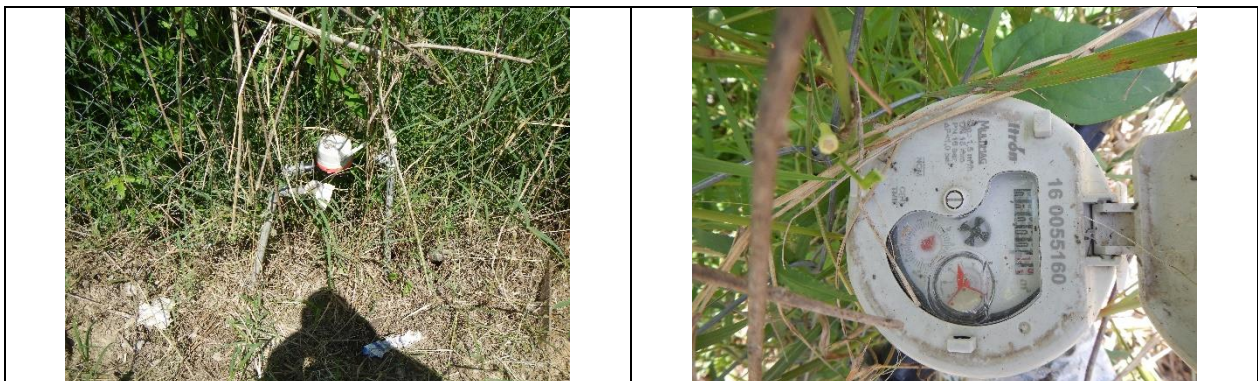
Figura 23. Medidor 160055160, Clase C. Predio con toma y detalle de medidor con número de serie. Colonia Vista Hermosa, comunidad de Jalpan de Serra. Lectura del medidor: 0.00 m 3 . El medidor de
