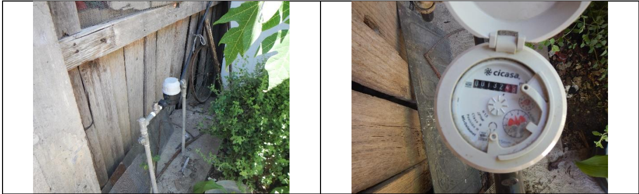
Figura 12. Medidor 16230830, Clase B. Predio con toma y detalle de medidor con número de serie. Con VAF. Colonia Vivah, comunidad de Jalpan de Serra. Lectura del medidor: 132.48 m 3 . Se encontró que el modelo de medidor no corresponde al registrado en el padrón de usuarios de la CEA.
