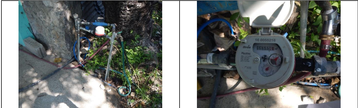
Figura 3. Medidor 160055216, Clase C. Predio con toma y detalle de medidor con número de serie. Con VAF. Barrio Alcantarillas, municipio de Jalpan de Serra. Lectura del medidor: 88.25 m 3 .
