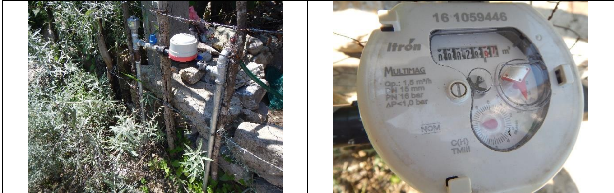
Figura 9. Medidor 161059446, clase C. Predio con toma y detalle de medidor con número de serie. Con VAF. Barrio San Esteban. Lectura del medidor: 28.97 m 3 . El número de medidor corresponde con el número proporcionado por la CEA, sin embargo la marca, modelo y características (clase) del medidor no corresponden a las registradas en el padrón de usuarios.
