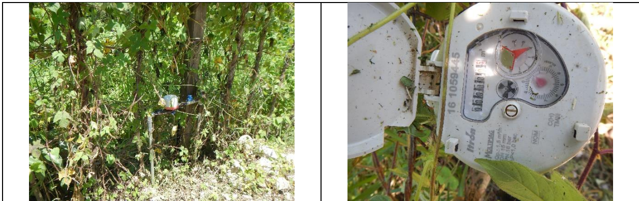
Figura 7. Medidor 161059445, clase C. Predio con toma y detalle de medidor con número de serie. Con VAF. Barrio San Esteban. Lectura del medidor: 0.06 m 3 . El número de medidor corresponde con el número proporcionado por la CEA, sin embargo la marca, modelo y características (clase) del medidor no corresponden a las registradas en el padrón de usuarios.
