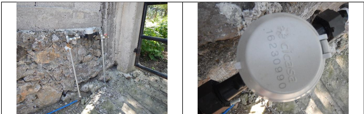
Figura 5. Medidor 16230990, clase B. Con VAF. Barrio Chacatlán. Lectura del medidor: 34.41 m 3 . El modelo del medidor presenta diferencias con las características registradas por la CEA, en el padrón de usuarios.
