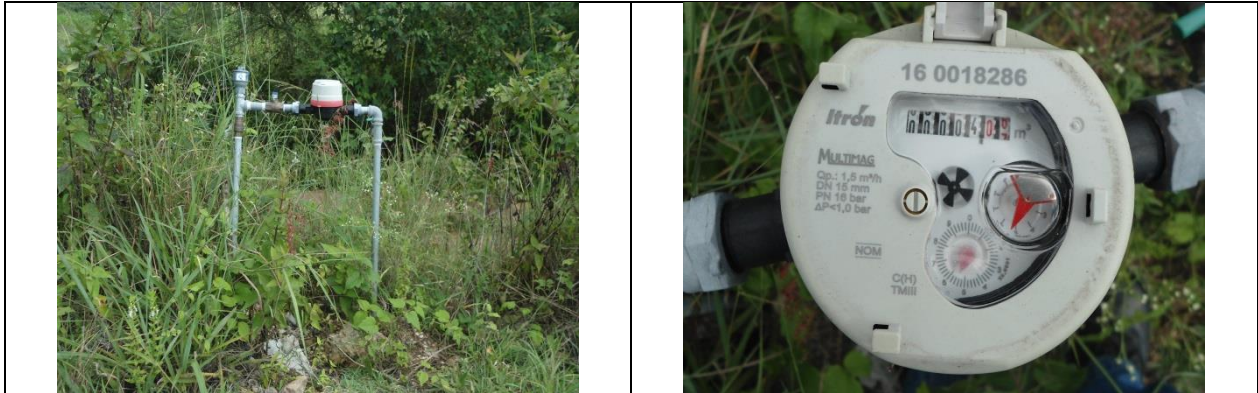
Figura 31. Medidor 160018286, clase C. Toma y detalle de medidor con número de serie. Con VAF. Calle San Francisco S/N, localidad El Malpais. Lectura del medidor: 4.06 m 3 . Se encontró que el modelo del medidor no corresponde al registrado en el padrón de usuarios de la CEA.
