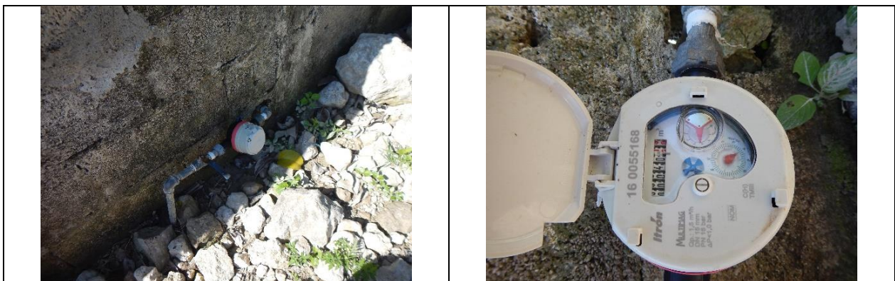
Figura 14. Medidor 160055168, clase C. Sin VAF. Localidad Encino Solo. Lectura del medidor: 40.19 m 3 . Se encontró que el modelo de medidor no corresponde al registrado en el padrón de usuarios de la CEA.
