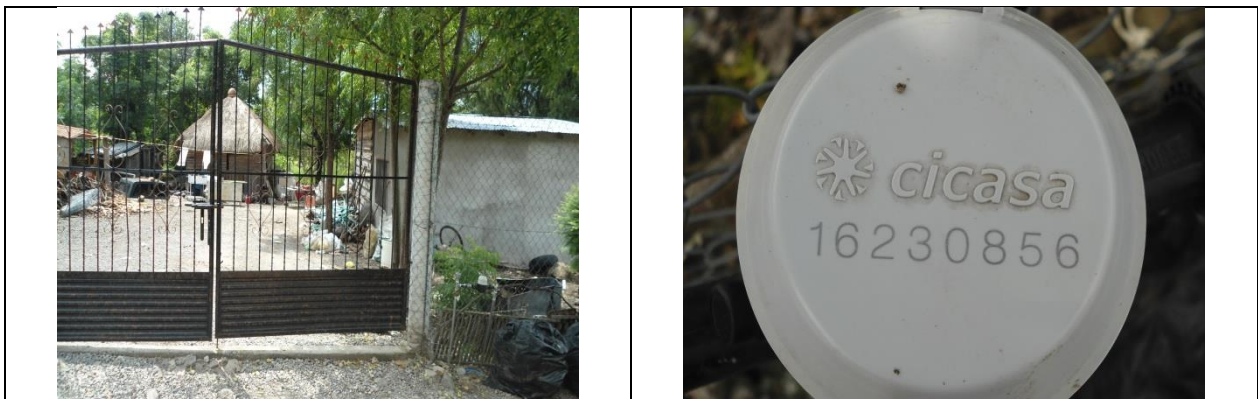
Figura 26. Medidor 16230856, clase B. Predio con toma y detalle de medidor con número de serie. Con VAF. Calle Camino Real S/N, localidad La Lagunita. Lectura del medidor: 60.80 m 3 . Se encontró que el modelo del medidor no corresponde al registrado en el padrón de usuarios de la CEA.
