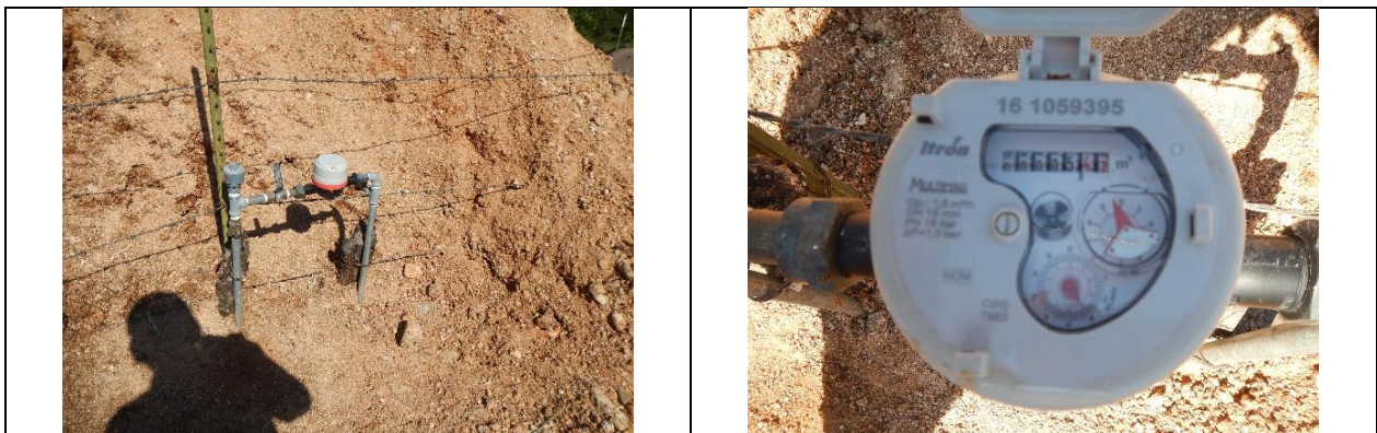
Figura 11. Medidor 161059395, clase C. Predio con toma y detalle de medidor con número de serie. Sin VAF. Barrio San Miguel. Lectura del medidor: 5.47 m 3 . El número de medidor corresponde con el número proporcionado por la CEA, sin embargo la marca, modelo y características (clase) del medidor no corresponden a las registradas en el padrón de usuarios.
